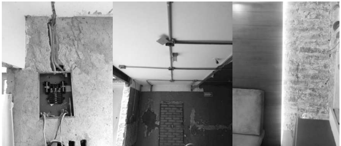
Figura 44 - 46 : Detalles de instalación eléctrica
