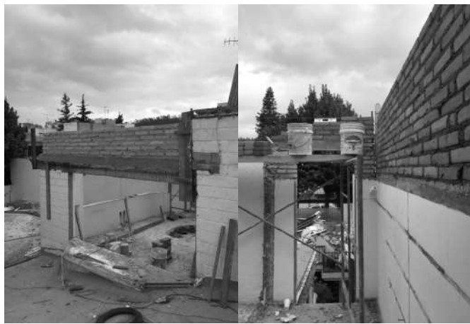
Figura 26 y 27: Corrección en ajustes de muros y pretilos
