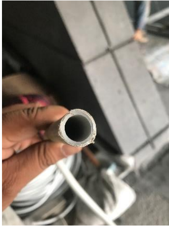
Figura I.81 Detalle de la manguera utilizada para el piso radiante (3/4 pulg. Diámetro)
