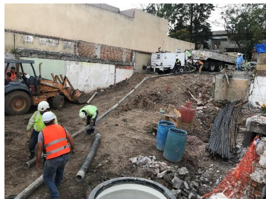
Figura I.32 Tendido tubular para el paso del concreto a la pila de energía
