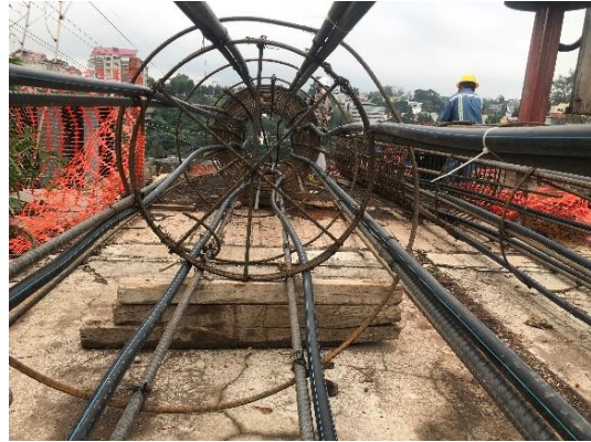
Figura I.16 Vista interior desde la parte inferior de la pila de energía.
