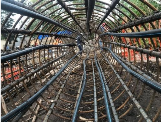
Figura I.9 Vista del armado de las mangueras en las pilas de energía.
