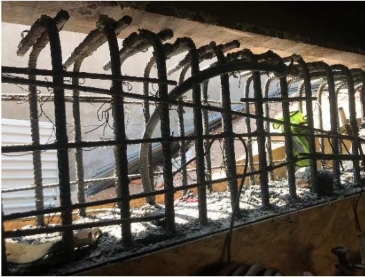
Figura I.69 Mangueras de polietileno sobresaliendo del muro de concreto
