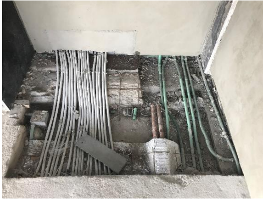
Figura I.75 Vista de las mangueras que pasan a través del piso radiante y que provienen del circuito primario
