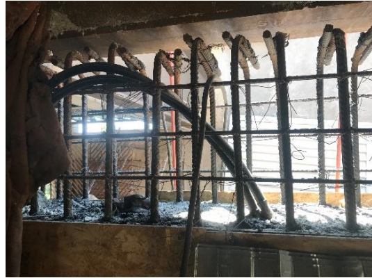
Figura I.70 Mangueras de polietileno sobresaliendo del muro de concreto
