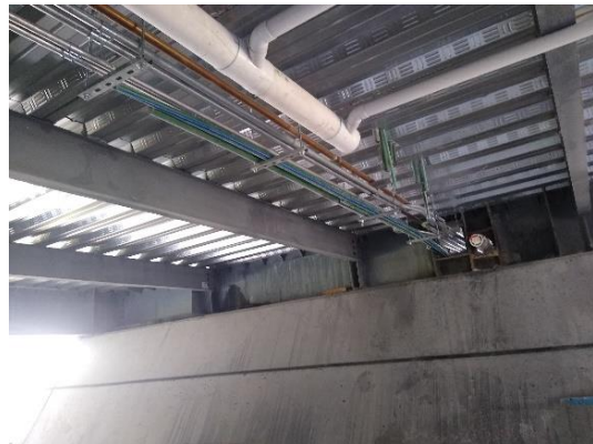
Figura I.84 Vista de las mangueras y tuberías ancladas a muros y debajo de techumbre
