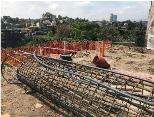
Figura I.11 Parte superior de las pilas de energía.
