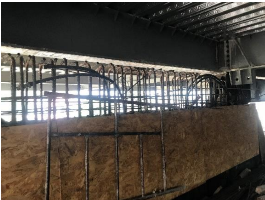
Figura I.67 Mangueras de polietileno sobresaliendo del muro de concreto
