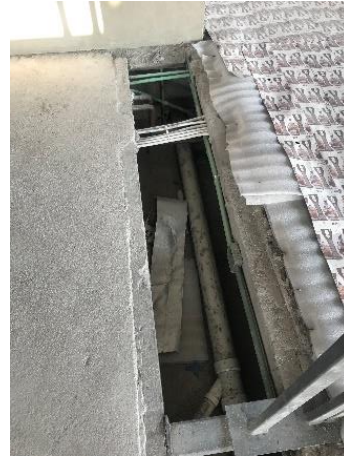
Figura I.76 Vista de las mangueras que pasan a través del piso radiante y que provienen del circuito primario
