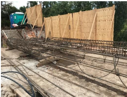
Figura I.17 Habilitado pilas de energía.
