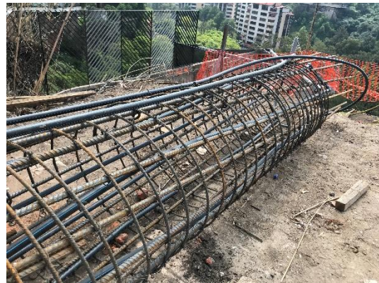
Figura I.12 Parte superior de las pilas de energía.
