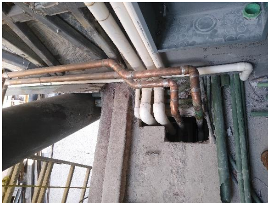
Figura I.83 Vista de las mangueras y tuberías ancladas a muros y debajo de techumbre
