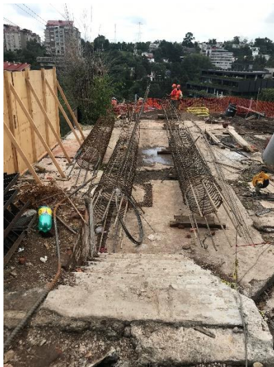
Figura I.13 Armado de pilas de energía previo a las pruebas de purgado.
