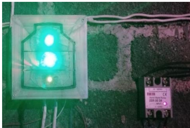
Ilustración 4.24 Encendido bomba presurizadora.
