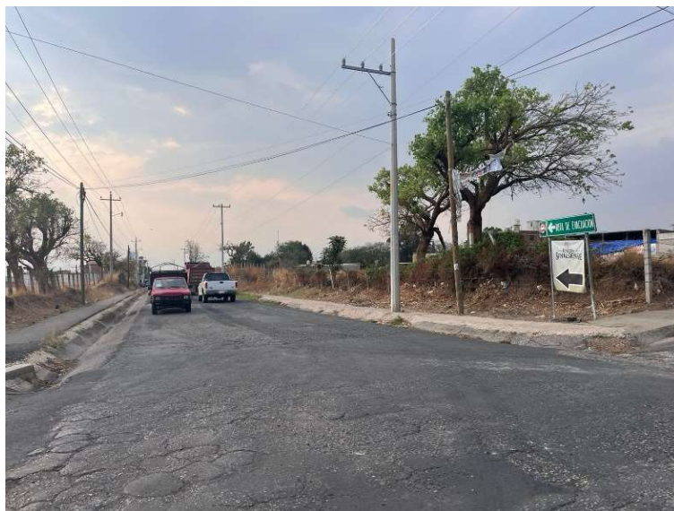
Ilustración 15. Ruta de Evacuación de Morelos en mal estado. Fuente: Propia.
