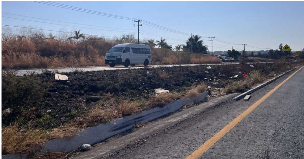
Ilustración 20. Falta de limpieza en derecho de vía de Carreteras del Estado de Morelos. Fuente: Propia.
