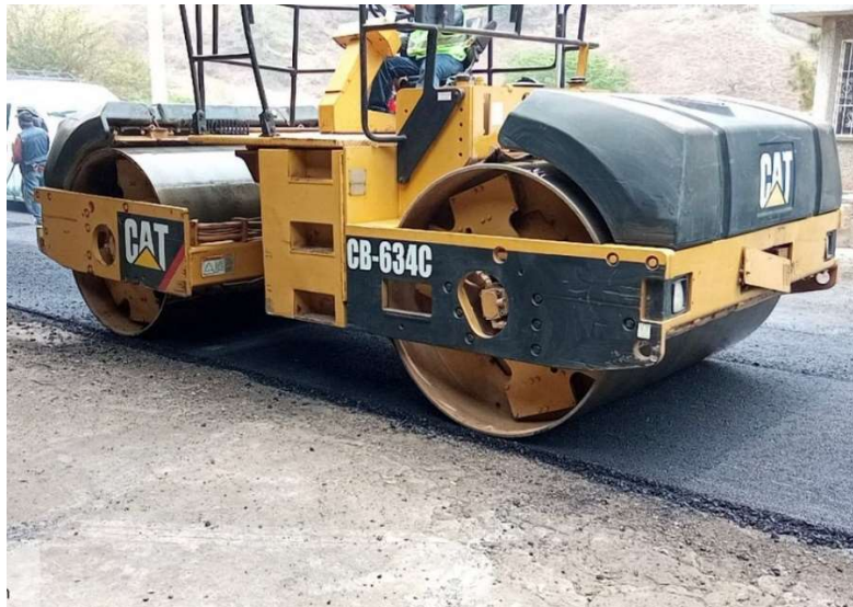
Ilustración 22. Construcción de Carretera con espesores deficientes. Fuente: Propia.
