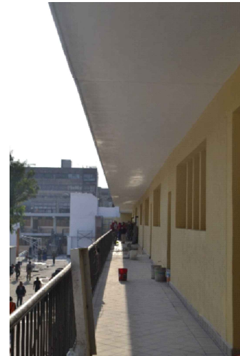
⑤ Pasillo con plafón remodelado sin instalación de luminarias.
