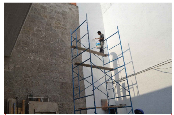
① Tratamiento de sillares de cantera en muro de fachada historica, como trabajos finales de intervención.
