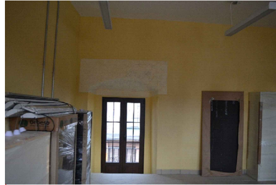
③ Evidencia de pintura mural en enmarcamiento, se observa el desnivel que se encuentra todavía en esta aula.
