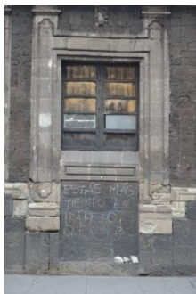
IMAGEN 40. Daño de pintura vandálica en ventana tapiada OCTUBRE 2014.
