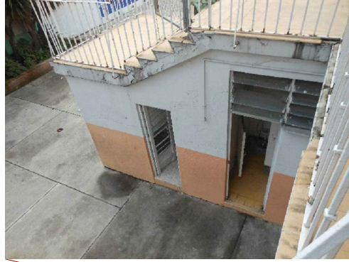
3 Baño de profesores adecuado en rampa inferior de las escaleras, se observa un deterioro en el recubrimiento así como pérdida parcial de este.
