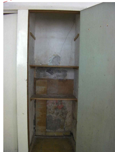
5 Presencia de humedad ascendente en bodega, ubicado en muro de fachada histórica.
