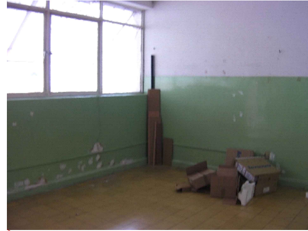
2 Salón usado como almacén de desayunos, presenta pérdida de recubrimiento, la pintura del guardapolvo es inadecuado por ser esmalte.
