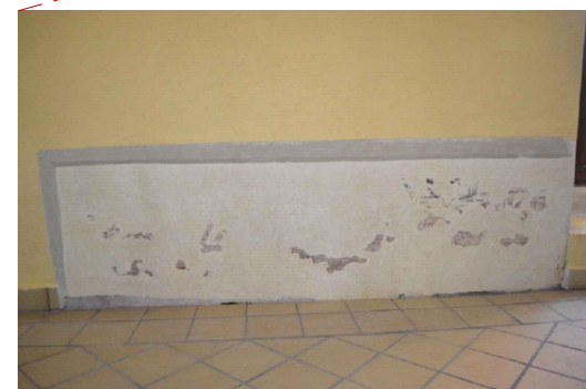
⑥ Evidencia de pintura mural en guardapolvo o parte baja del muro.
