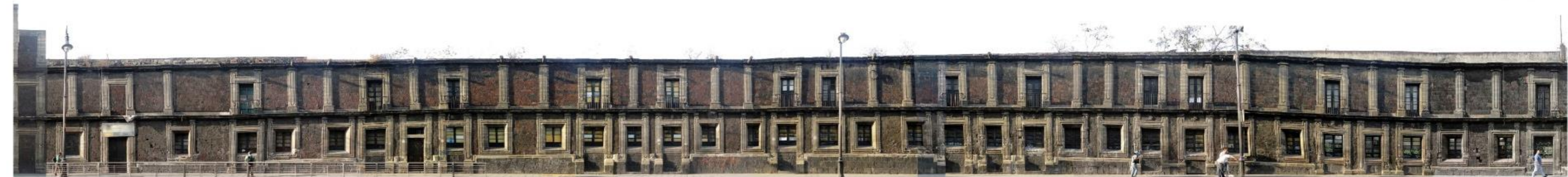
FACHADA CON DETERIOROS ANTES DE LA INTERVENCIÓN
