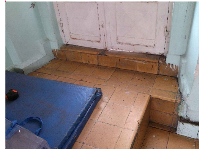
⑤ Escalón que se ubica en puerta de balcón, como parte de los desniveles que se encuentran en el edificio.
