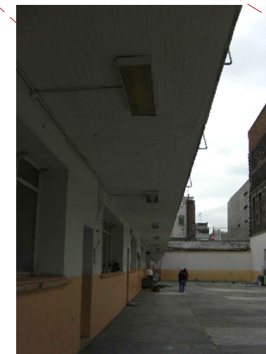
7 Corredor de acceso aulas planta baja, se observa cables de instalaciones expuestas al intemperie.
