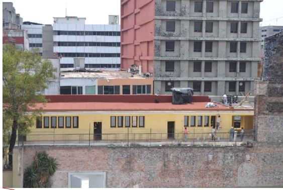
① Vista desde Secundaria No. 1, observando los trabajos de remodelación del edificio A, del conjunto del plantel.
