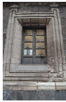
IMAGEN 41. Pieza deteriorada en esquina de ventana, OCTUBRE 2014.
