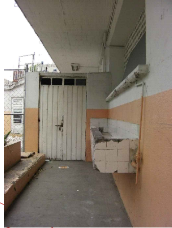
2 Se identifica cuarto de bombas para el abastecimiento de agua potable en todo el plantel.
