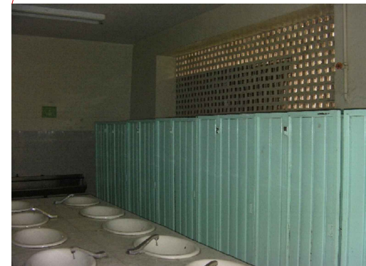
10 El mobiliario en los baños es inservible, presenta instalación general sanitaria inservible, las mamparas presentan grado de oxidación, se observa un guardapolvo cerámico colocado a una altura de 1.20 cm., en todo el espacio de los sanitarios.
