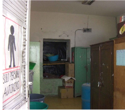
1 Bodega de Conserjería, se observa pérdida del recubrimiento, por humedad ascendente.
