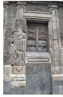
IMAGEN 42. Piezas con pérdida total, por intemperismo y exfoliación, OCTUBRE 2014.
