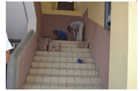
⑧ Colocación de piso ceramico de loseta amarilla de 20X20, en escaleras de comunicación del edificio A.
