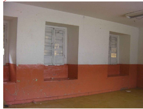
8 Aula con mobiliario, podemos observar una franja colocada en los muros, de pintura esmalte, alterando la estética y transpiración del muro.
