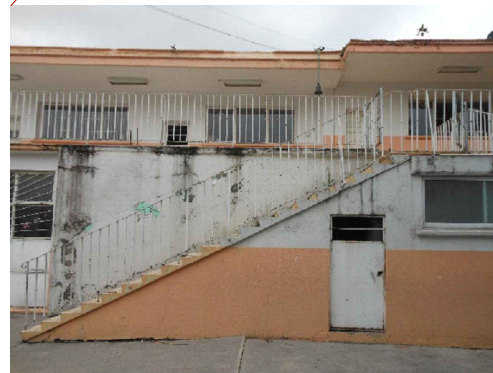
9 Ecurrimiento en muros exteriores por acumulación de humedad, podemos observar corrosión en barandal de escaleras y del pasillo en planta alta por falta de recubrimiento.
