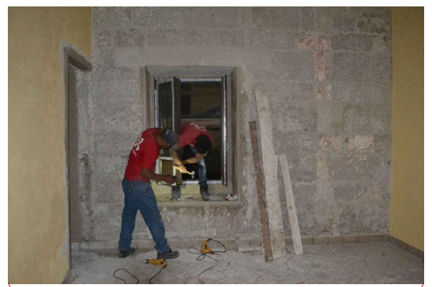
② Colocación de ventana de PVC., así como liberación de aplanado en sillares de cantera con indicios de pintura mural.
