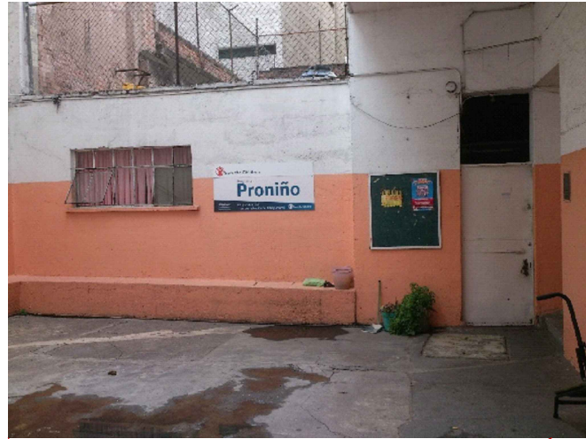
① Muro de Casa de Conserjería, se observa recubrimiento en mal estado, guardapolvo de pintura esmalte inadecuado. Se identifica el paso de instalaciones hasta el momento desconocidas expuestas al intemperie. E
