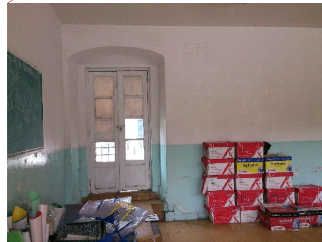
④ Aula que presenta recubrimiento en mal estado, se identifica desnivel en escaleras de balcón, la cancelería de la puerta presente pérdida de cristales en ventanas así como corrosión de la misma. En todo el espacio se presente un guardapolvo de pintura esmalte inadecuado.
