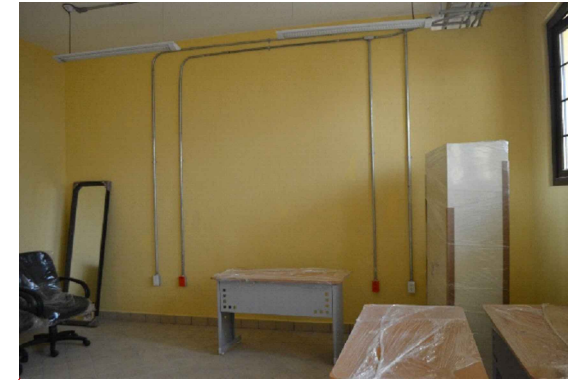
④ Canalización de instalación eléctrica sobre la superficie de muros y plafón del aula.
