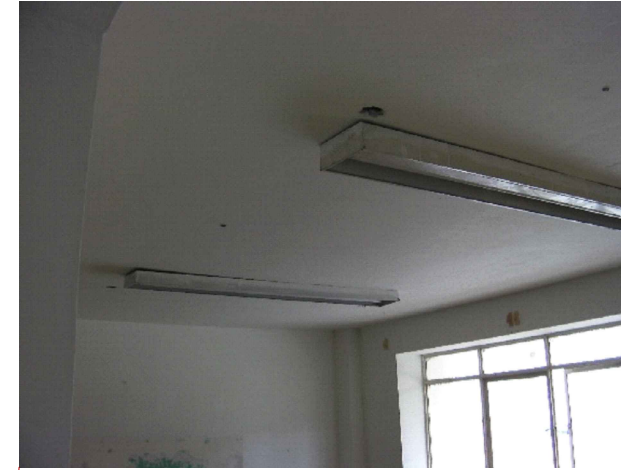
3 Se observa luminarias inservibles, así como modificaciones en la colocación de los registros de las luminarias.
