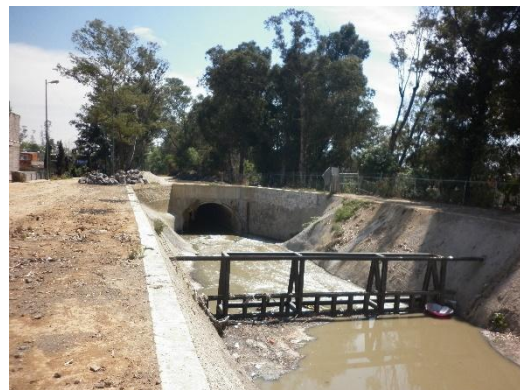
Fotografía 4: parte sin entubar. Colonia San Bartolo, Xochimilco. Fuente: Fotografía propia.
