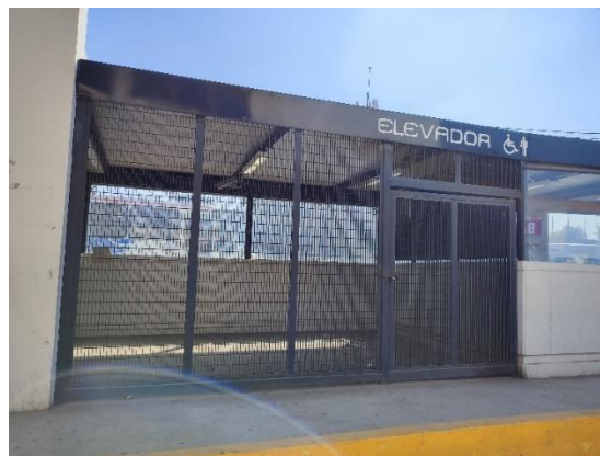
Ilustración 42. Elevador sin funcionar en el acceso sur de Martín Carrera.
