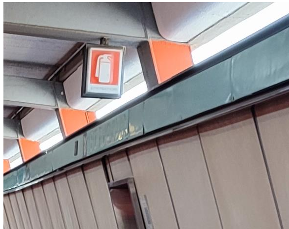
Ilustración 49. Señalamiento de extintor en Bondojito
