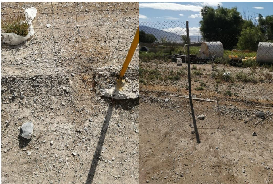
Ilustración 9 Falla en el cerco perimetral.
