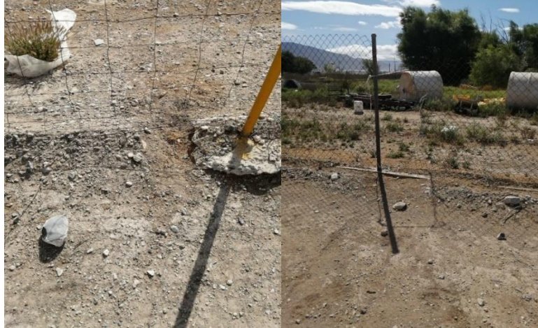
Ilustración 15 Falla en el cerco perimetral.
