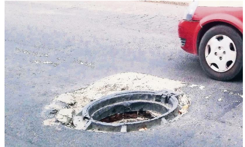
GRAF.184 / IMAGEN; ROBO DE COLADERA, PROVOCANDO UN PELIGRO A LOS AUTOMOVILISTAS Y TRANSEUNTES (Nota 1) https://www.eluniversal.com.mx/metropoli/piden-cambiar-coladeras-metalicas-por-las-de-plastico-para-evitar-robos-en-cdmx
