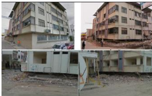
Figura 2.14 Aplastamiento del primero nivel en edificaciones con PBD en el sismo de Ecuador, 2016 (Lotto y Stein, 2016)
