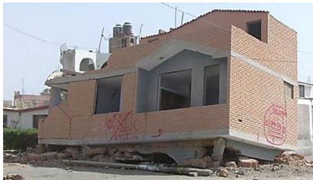
Figura 2.11 Configuración típica de edificios con PBD dañados en el sismo de Perú, 2007 (Páez et al. , 2017)
