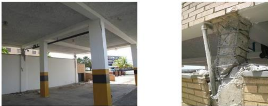
Figura 1.5 Daños en edificios con patología de columna corta. (Beauperthuy y Urich, 2011)
