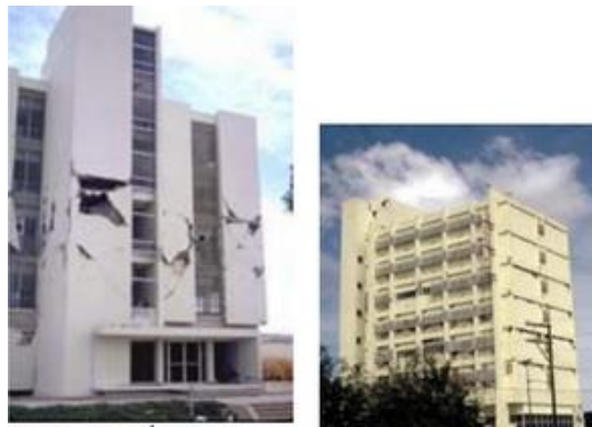
Figura 1.3 Daños en edificios con irregularidad en elevación (Tena, 2010)
