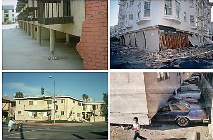
Figura 2.10 Daños en edificios con PBD, sismo de Northridge, 1994 (Páez et al. , 2017)
