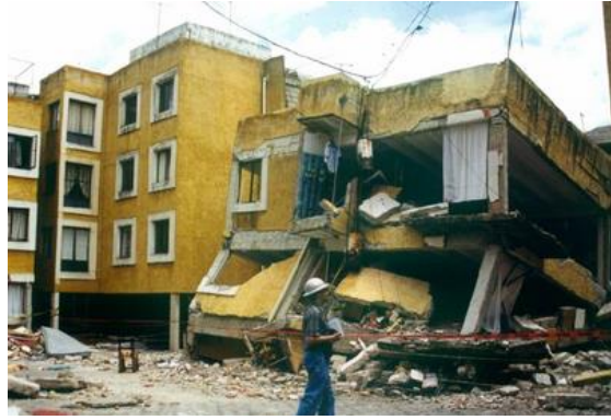
Figura 1.2 Colapso de edificios con planta baja débil en el centro de la ciudad de Puebla (Tena, 2004)
