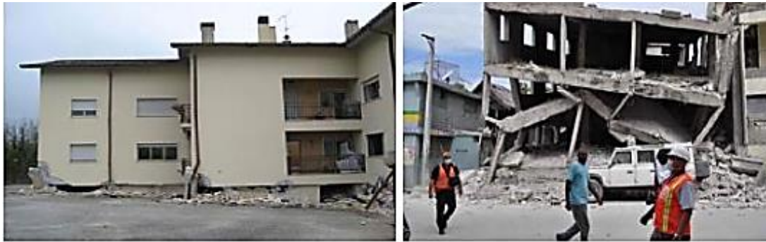
Figura 2.12 Edificio colapsado por problemas de PBD en el sismo de Haití, 2010 (Páez et al. , 2017)
