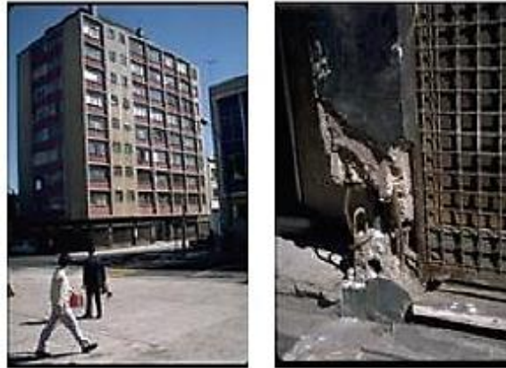
Figura 2.7 Daños en edificio con PBD, sismo de Valparaíso, 1985 (Páez et al. , 2017)
