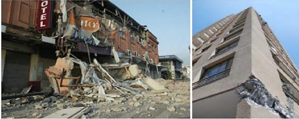
Figura 2.13 Daños y colapso de edificaciones con problemas de PBD en el sismo de Chile, 2010 (Hernández, 2012)
