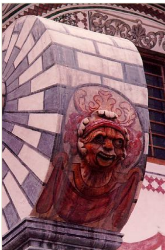
Detalle de botarel del Real Beaterio de Santa Rosa de Viterbo, Querétaro. Foto: Armando Arias
