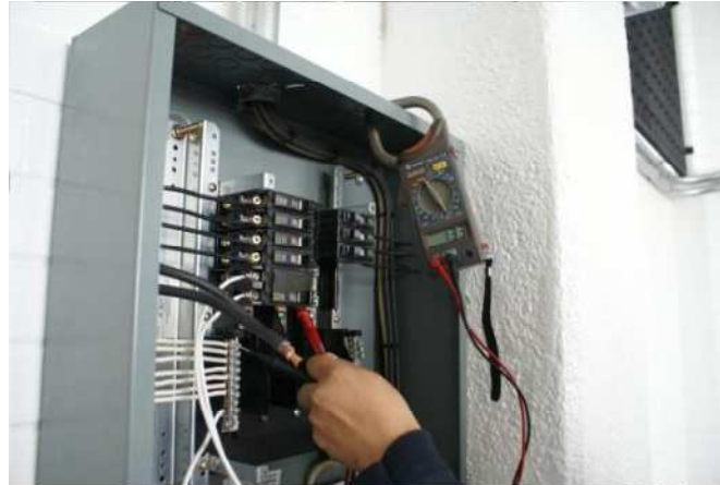
Figura 3.3 Conexión de cable en el tablero del laboratorio de idiomas_2. Elaboración personal (2010).
