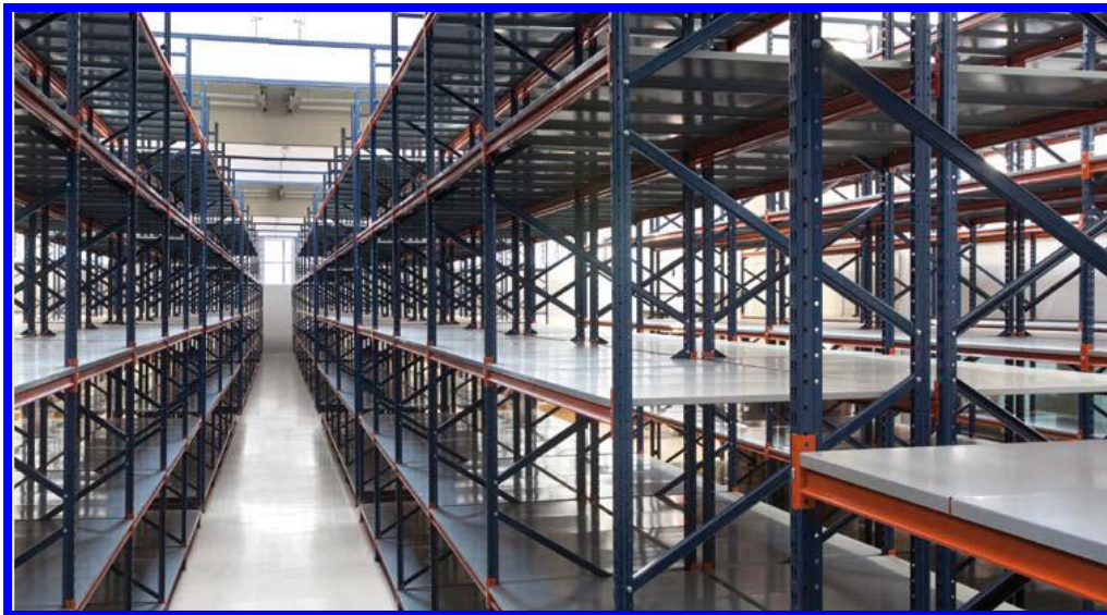
Fig. 90 Instalación del sistema de Racks.
