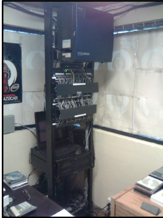
Figura 1.3 Vista final del Rack después de su desarrollo de mantenimiento. (Imagen original).
