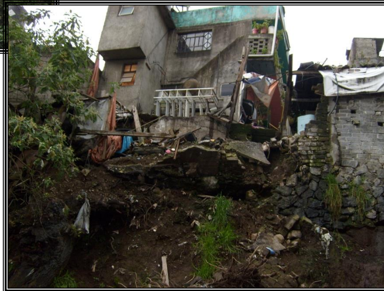
Figura No. 5.- Edificación en zona de relleno heterogéneo, catalogada de alto riesgo. Calle Fco. I Madero, col Lomas de la Era.
