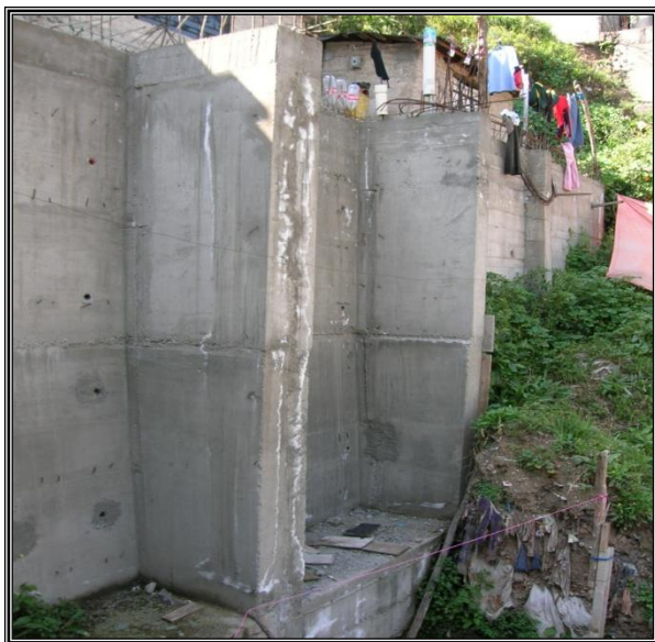
Figura No. 16.- Muro de concreto en calle Pino Colonia Garcimarrero Sur.
