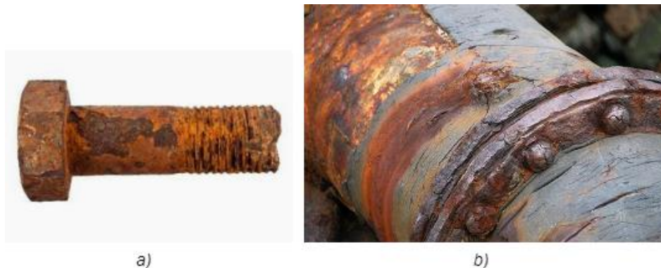
a) b) Figura 16a y 16b.- Ejemplos de oxidación y corrosión en tornillo y tubería Nota: Imágenes tomadas de (Guevara, 2018) y (NERVION PINTURAS, s.f.)
