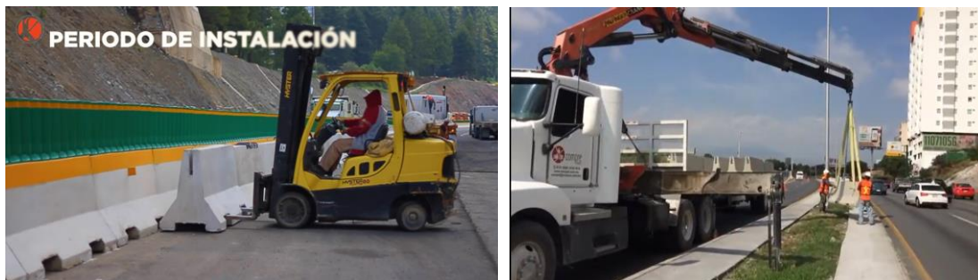
Fig.31 Colocación de barreras new jersey con grúas o montacargas en la vialidad.
