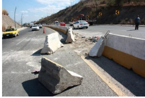
Fig.2 Imagen demostrativa de impacto vehicular contra muro de contención sin sistema de amortiguamiento, carretera las Flechas.
