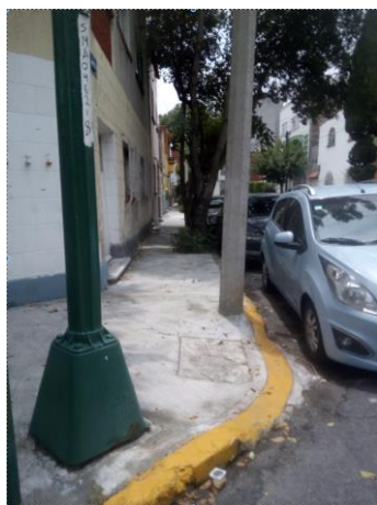
Fotografía 47. Se observa que la rampa no tiene la pendiente máxima de 8% para diseño universal.
