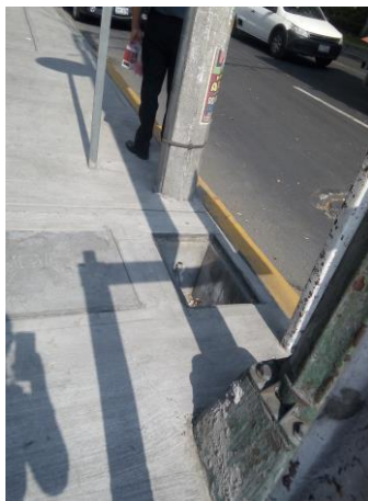
Fotografía 35. Av. Cuitláhuac. Falta una tapa de registro en la banqueta.
