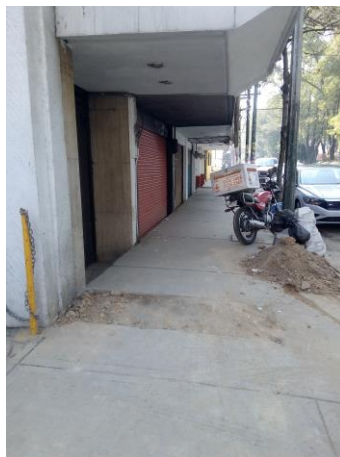
Fotografía 36. Av. Cuitláhuac, pavimento roto por reparaciones, motocicleta estacionada en la banqueta.
