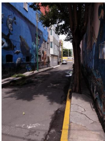
Fotografía 48. Cda de Nogal. El árbol ocupa todo el ancho de banqueta y ambas aceras el pavimento está roto y levantado.
