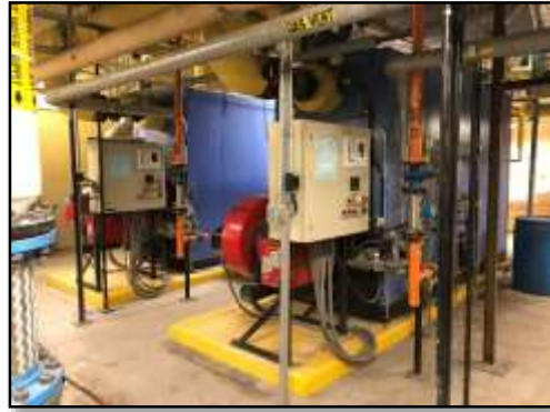
Figura 36. Equipos de calefacción, ventilación y aire acondicionado.
