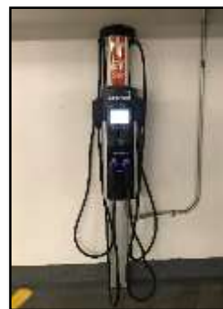
Figura 33. Estaciones de recarga de vehículos eléctricos.
