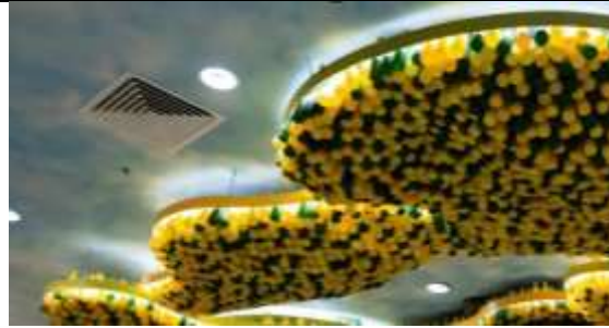
Figura 21. Sistema de aire acondicionado.
