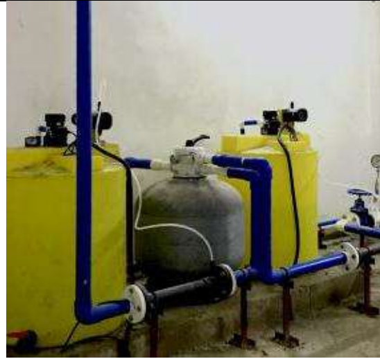
Figura 52. Sistema de reciclaje de agua.
