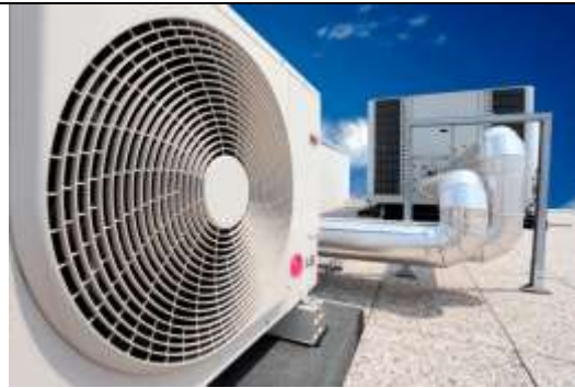
Figura 8. Sistemas de ventilación.
