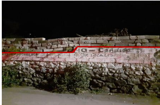
Imagen 4.3 Daños en la vivienda de la señora Berta Navarrete
