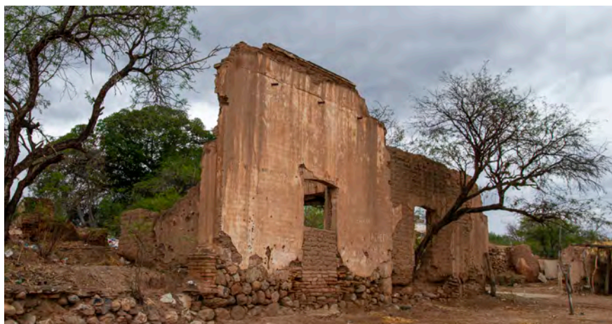
Fig. 7. Ruinas de las instalaciones de la hacienda de Nicolás de Ayotla, Oaxaca. Fotografía: Olivier Dubois, 2022.
