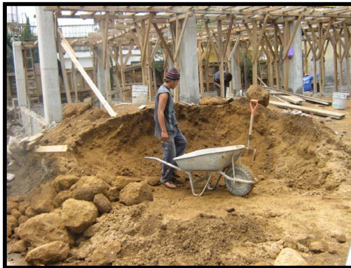
Imagen 4.21. Relleno del perímetro de la construcción y de la base del piso interior.
