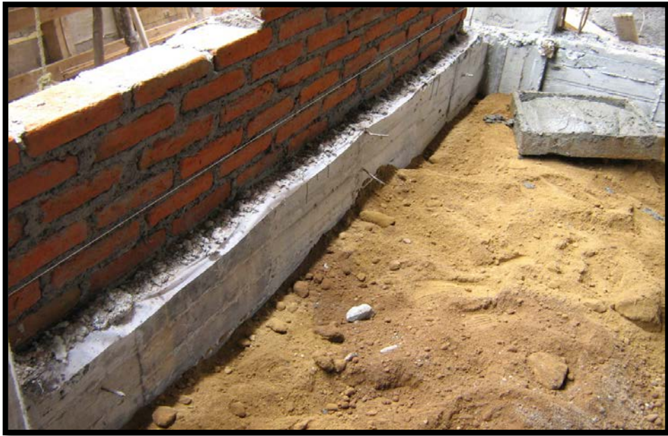
Imagen 4.34. Colocación de hiladas de tabique rojo recocido para la construcción de muros de tabique rojo recocido.
