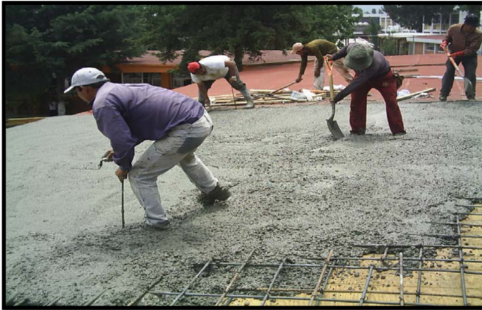
Imagen 4.29. Extendido del concreto bombeado y manejo de escantillones para establecer el espesor de la losa.
