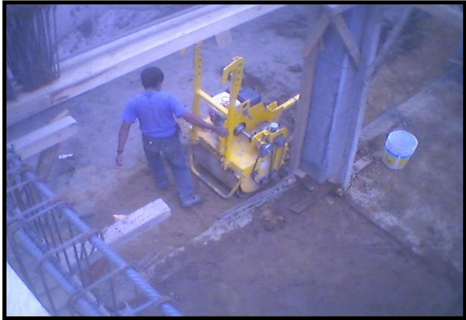
Imagen 4.22. Compactación del terreno de construcción con rodillo vibratorio para alcanzar un 90% de compactación.
