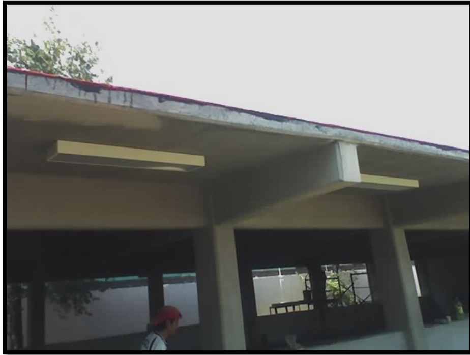
Imagen 4.47. Colocación de luminarias en el pasillo de la fachada frontal del salón.
