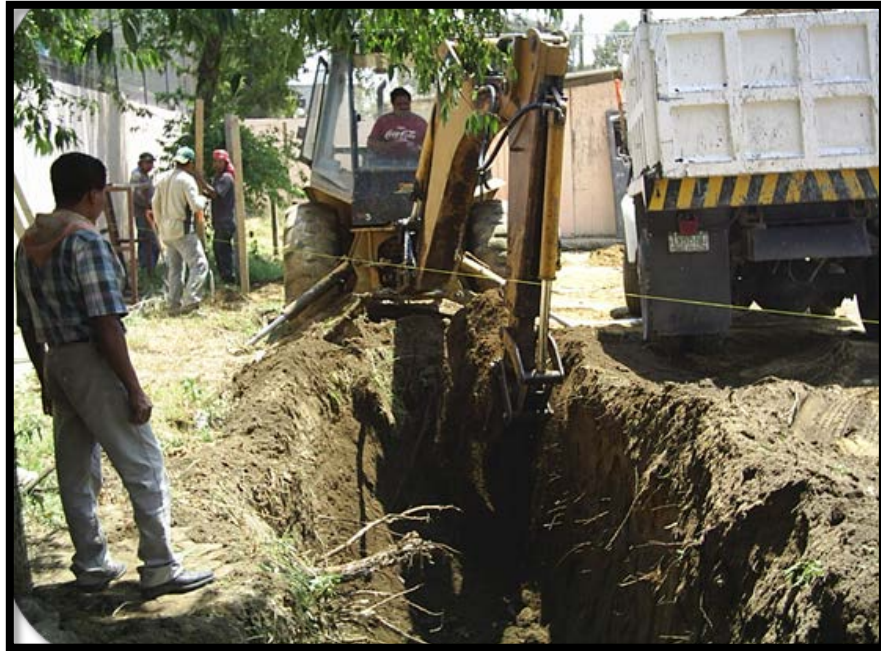
Imagen 2.14. Camión de volteo para transportar el material extraído del terreno al tiro correspondiente.
