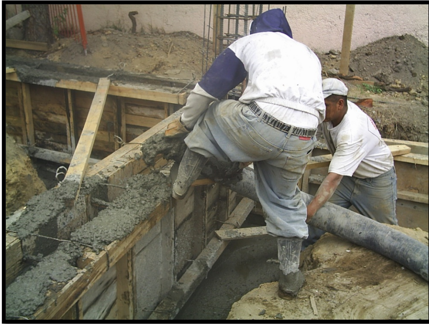
Imagen 3.16. Vaciado de concreto dentro de la cimbra de las zapatas de cimentación con bomba estacionaria.
