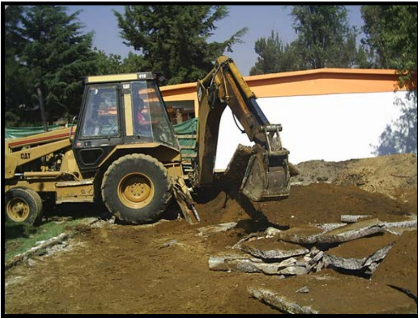
Imagen 2.6. Retiro de firme de concreto con el apoyo de una retroexcavadora de neumáticos.
