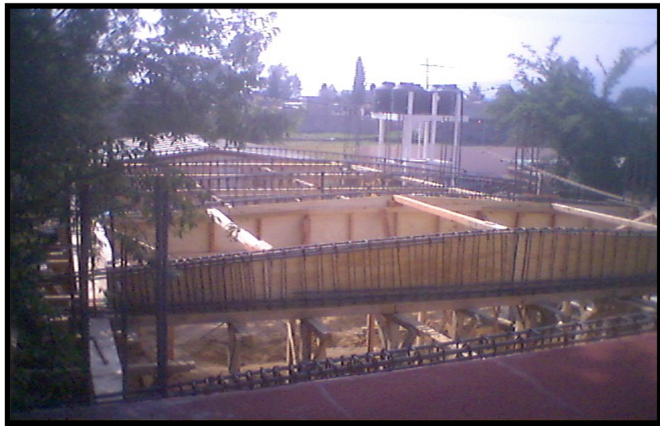
Imagen 4.20. Colocación de la cimbra en los costados laterales de las trabes de la losa.
