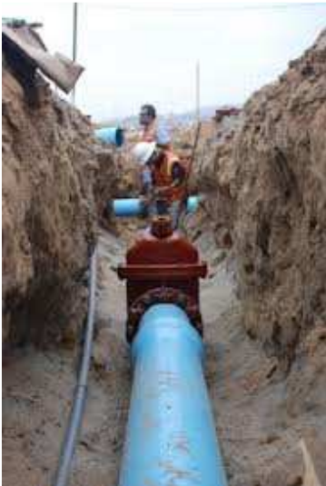
Figura 7.- Tubería Subterránea y válvula seccional
