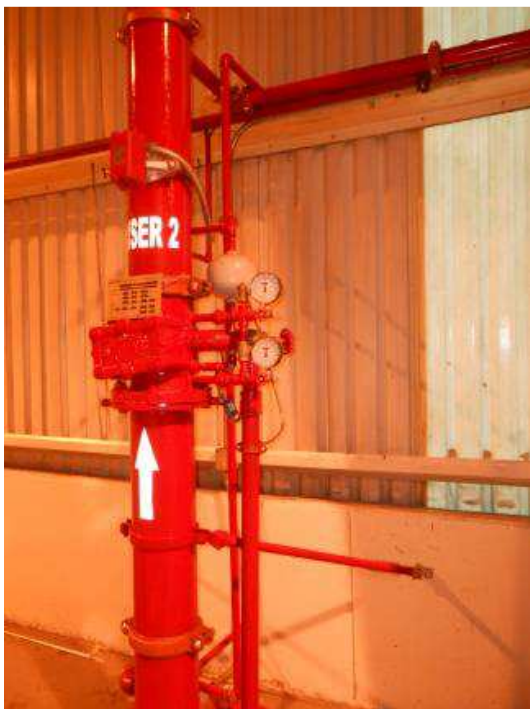
Figura 11.- Riser Principal de Rociadores o Sprinklers
