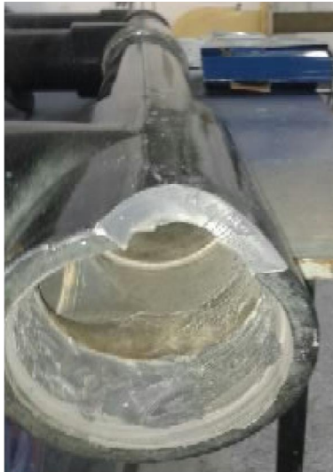
Imagen 47 – Vista horizontal de la tubería rota.
