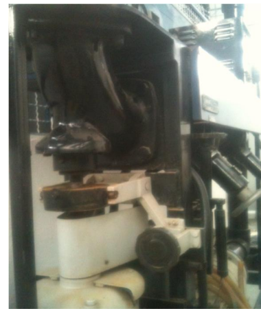
Imagen 37 – Muestra la posición de los componentes en el equipo, así como la guarda que protege al acoplamiento.
