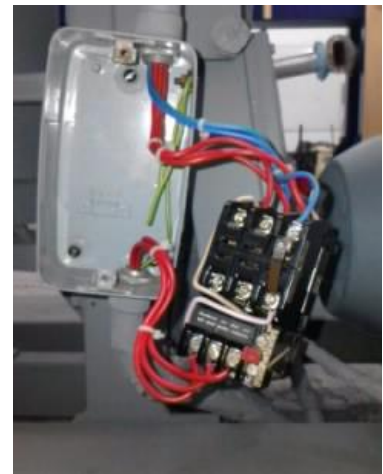
Imagen 71 – Se observa el interior de la botonera después del procedimiento de limpieza.
