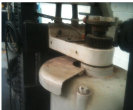
Imagen 33.- Motor/generador en condiciones iniciales.
