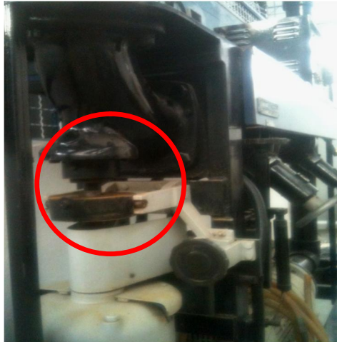
Imagen 27.- Localización de la fuga de agua.
