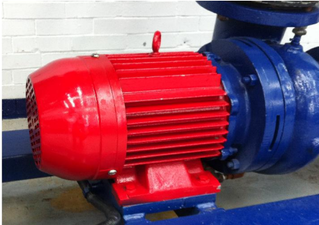
Imagen 17 – Muestra la bomba acoplada al sistema hidráulico.
