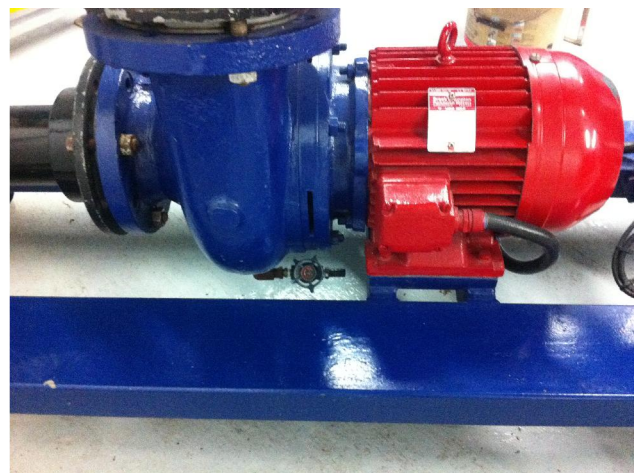
Imagen 117 – Se señala la localización de la válvula de drenaje.
