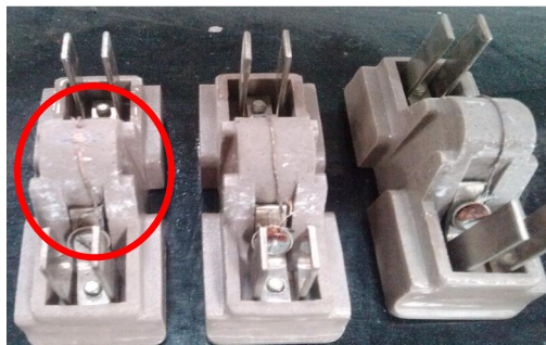
Imagen 50 – Muestra en el círculo rojo el fusible con el hilo de continuidad dañado.
