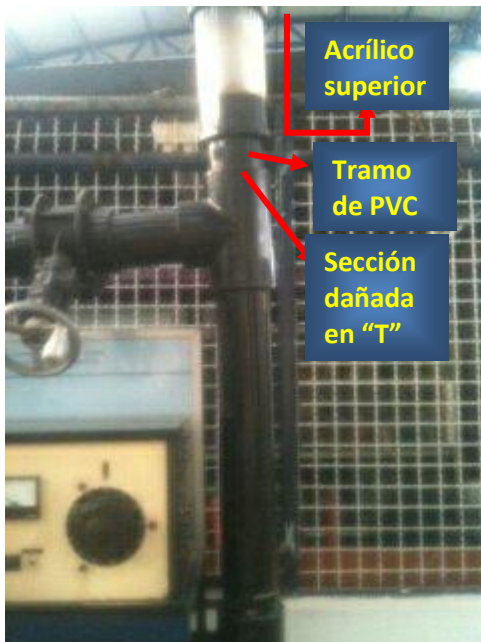
Imagen 69 – Se señalan el tubo a sustituir y las secciones a reparar.
