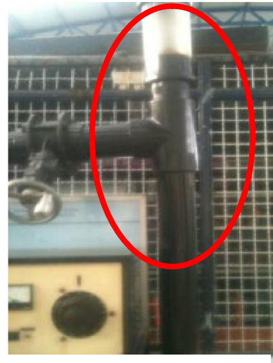
Imagen 49 – Se puede observar en el semi círculo rojo la sección de la tubería dañada y el tubo superior de acrílico que será sustituido.
