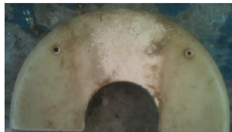
Imagen 62 – Se observa a una de las tapas del motor en condiciones iniciales
