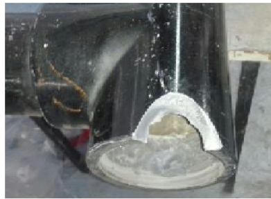
Imagen 48 – Vista superior de la parte dañada de la tubería.
