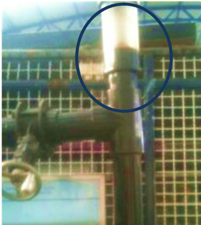
Imagen 58 – Muestra en círculo azul tubo de acrílico y secciones dañadas del sistema.
