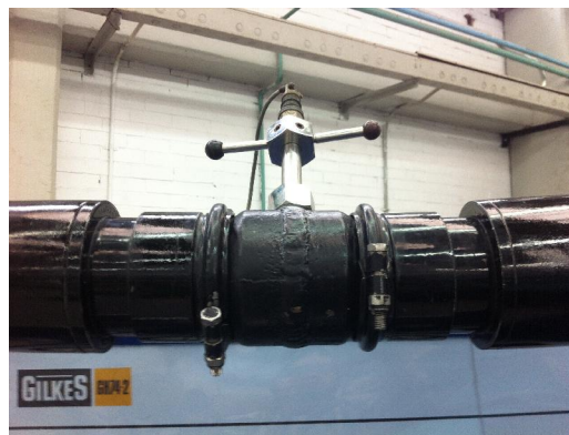
Imagen 116 – Se observa a la placa de aforo y las uniones en el sistema hidráulico.
