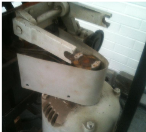
Imagen 42 – Guarda en el acoplamiento entre la turbina y el motor.
