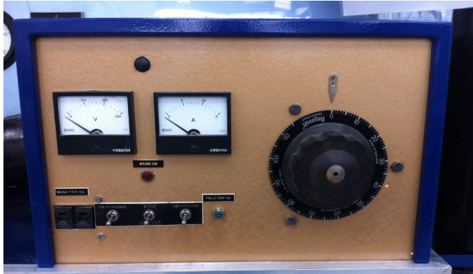
Imagen 20 – Se observa la unidad de control rehabilitada.
