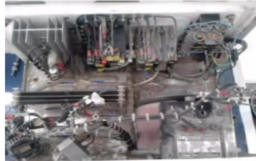
Imagen 53 – Se muestra la suciedad en el interior de la unidad de control.
