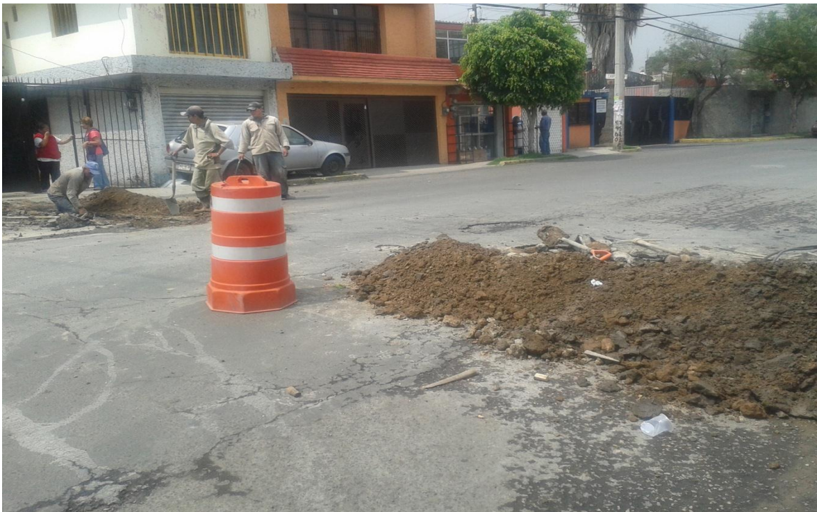
Mantenimiento a la fuga de agua en la avenida Cóndor. Foto: Ricardo Tang, 27 de septiembre del 2013.
