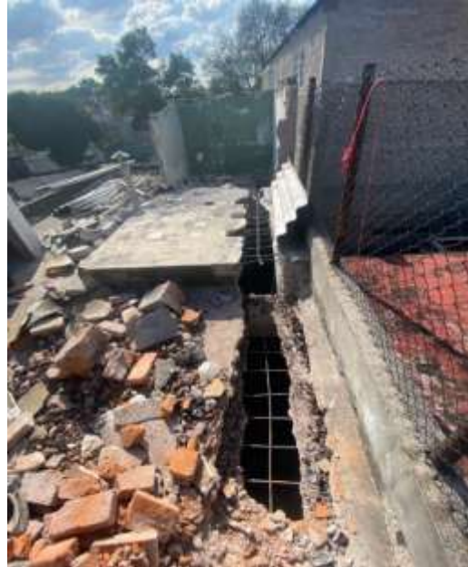
Separación de losa planta alta de muro colindante.
