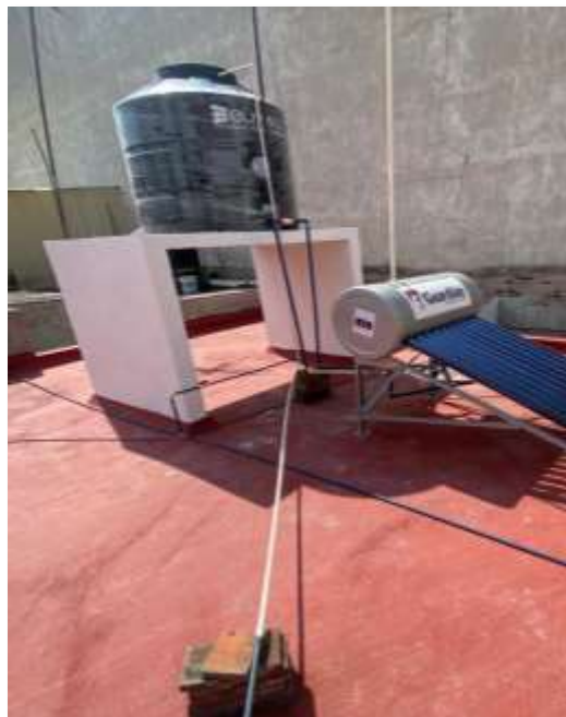
Conexión de tinaco, calentador solar y calentador de paso.
