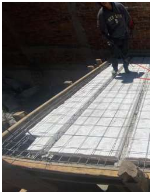
Colocación de malla electro soldada 8-8-6-6 en toda la superficie de la losa.
