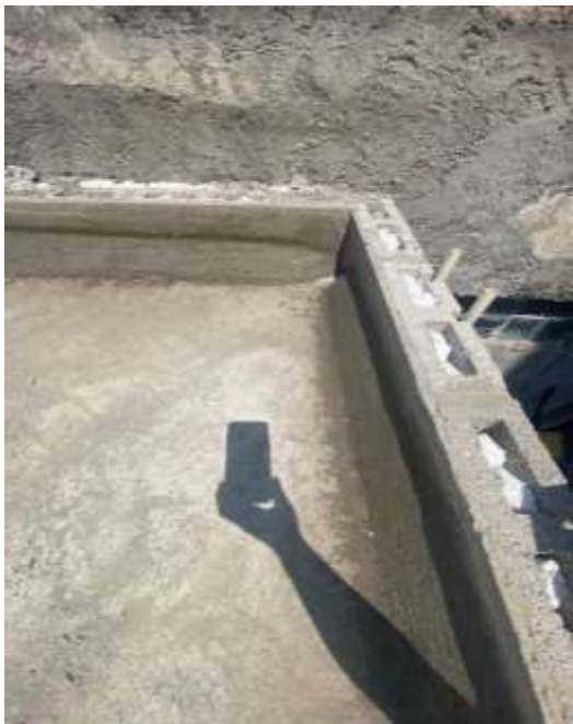
Chaplán de 7 cm en perímetro de azotea entre unión de losa y pretil.
