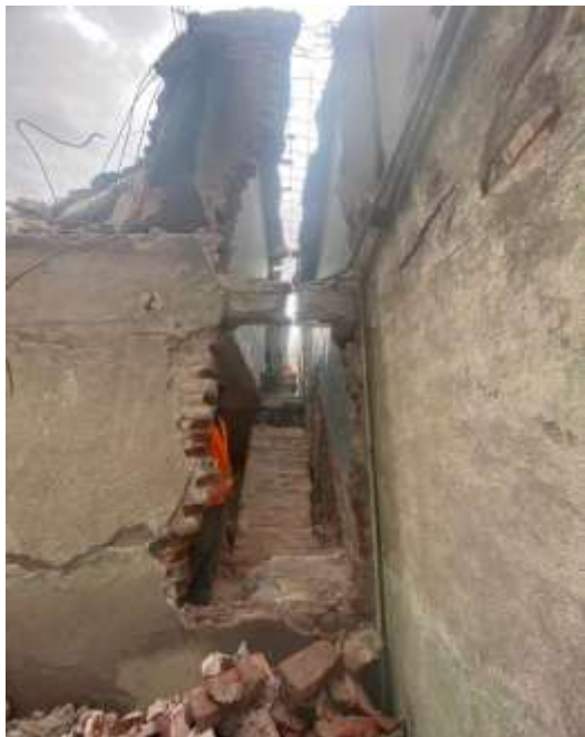
Separación de trabe y muros en planta baja.
