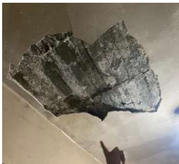
Plafón dañado en habitación de predio colindante
