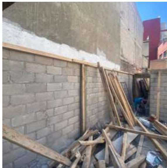
Colocación de vigas de nivelación en muros para recibir vigueta y bovedilla.
