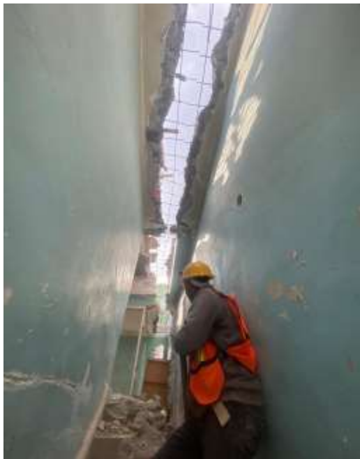
Muro colindante desligado de la estructura de la vivienda.
