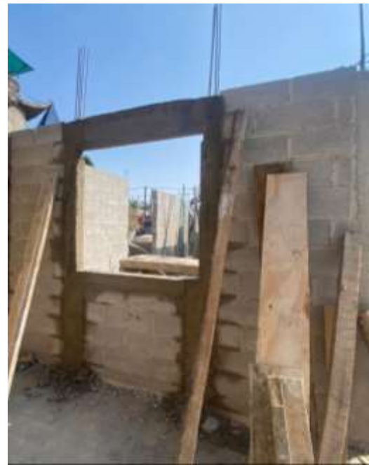
Ventanas y puertas confinadas en sus 4 lados.
