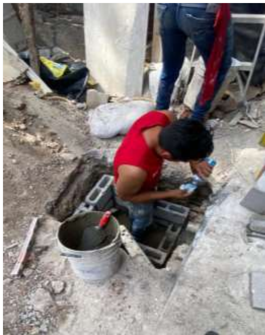
Conexión para descarga a drenaje.
