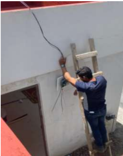
Conexión acometida eléctrica.
