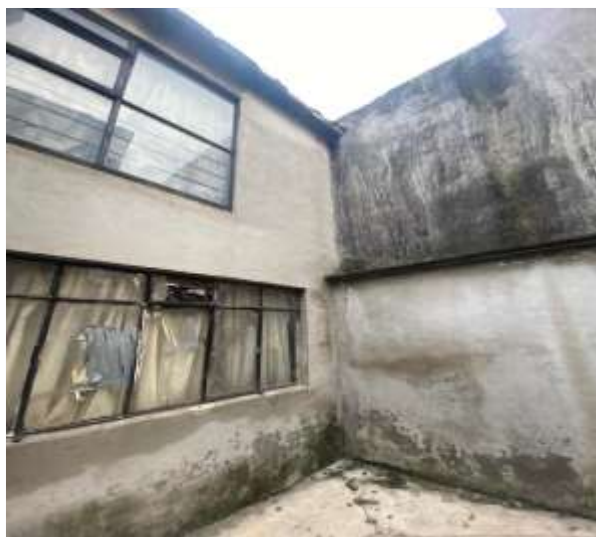
Patio trasero de vivienda colindante con afectaciones en ventanas y muros.
