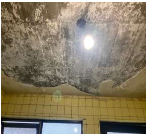
Plafón de cocina con desprendimiento de aplanado en predio colindante.
