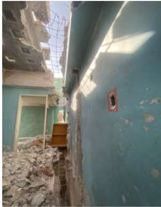
Separación de losa en planta baja de muro colindante.
