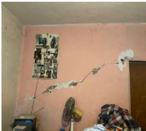
Grieta existente en muro de habitaciones de predio colindante.
