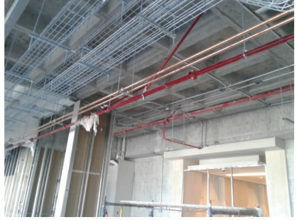
IMAGEN 2.10 MAGDALENA VAZQUEZ, Se puede apreciar las tuberías de PCI ya instaladas así como las tuberías de agua caliente y los Racks para el cableado de telecomunicaciones. Marzo del 2017, Fotografía.
