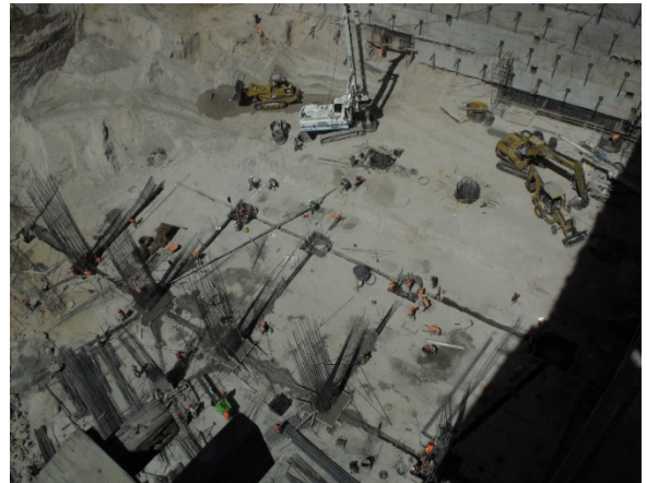
IMAGEN 1.9 C&W, Vista de excavación profunda e inicio de cimentación del edificio, febrero 2015, Fotografía.
