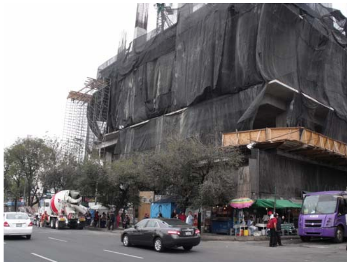
Vista de levantamiento de losas de torre zona noreste, se aprecian el inicio de la cimbra para los volados perimetrales de los niveles de oficina de la torre
