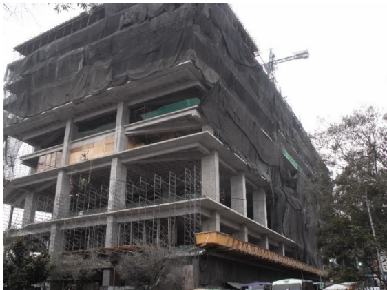
IMAGEN 1.14 MAGDALENA VAZQUEZ, Se aprecia ya colado el nivel 4, 1er nivel de oficinas y cimbra para el nivel 5 ejes, noviembre 2015, Fotografía.
