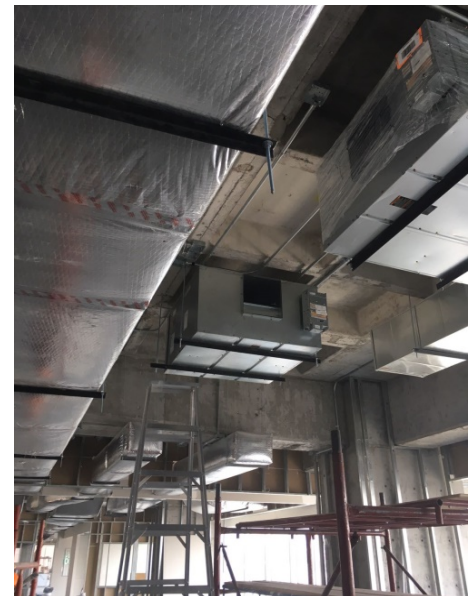
IMAGEN 2.8 MAGDALENA VAZQUEZ, Vista de la instalación de aire acondicionado Ductos y VAV's. Junio del 2017, Fotografía.
