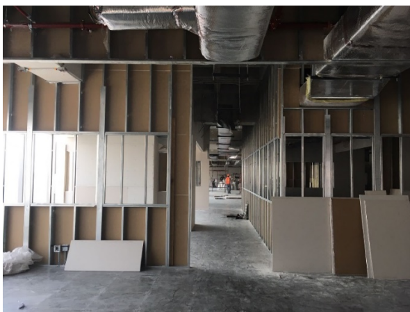
IMAGEN 3.1 MAGDALENA VAZQUEZ, En esta fotografía se puede apreciar el piso falso completamente instalado, así como el inicio de los trabajos de alzado de muros. Julio del 2017, Fotografía.
