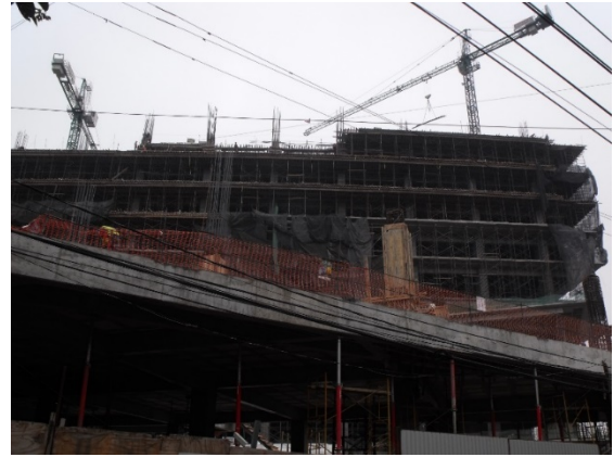
IMAGEN 1.15 MAGDALENA VAZQUEZ, Se aprecia ya colado el nivel 4, 1er nivel de oficinas y cimbra para el nivel 5 ejes, además de la sección de volados zona de comercio., noviembre 2015, Fotografía.
