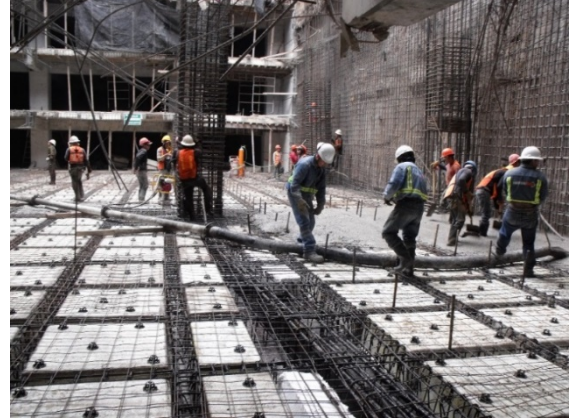
IMAGEN 1.13 C&W, Vista de losa tapa sótano 10 durante el proceso de colado, con este colado quedan prácticamente terminados los sótanos 12, 11,10 en función de estructura., septiembre 2015, Fotografía.
