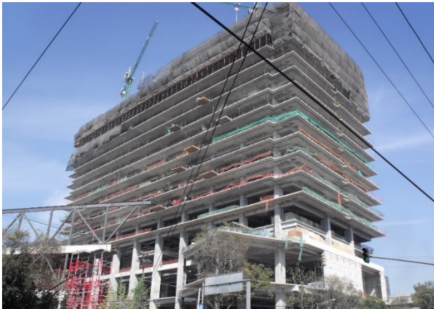
IMAGEN 1.16 MAGDALENA VAZQUEZ, Se aprecia el nivel 16, el cual en este momento se encuentra colado al 100%, además de parte de la cimbra para el nivel 17. febrero 2016, Fotografía.
