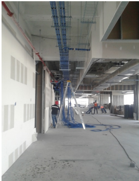
IMAGEN 2.7 MAGDALENA VAZQUEZ, En esta fotografía se muestra el proceso de cableado de datos. Abril del 2017, Fotografía.
