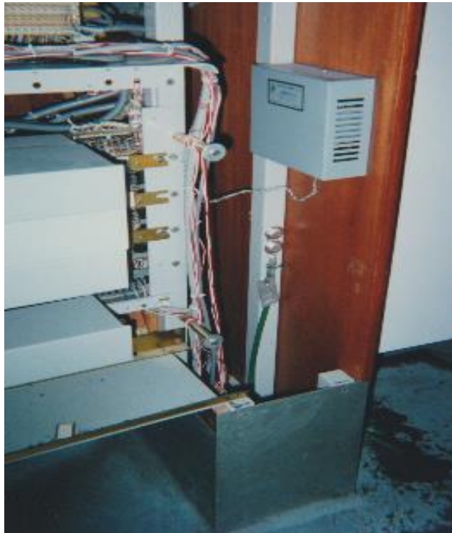
Fig. 20 Conexión de equipo relacionado con el funcionamiento del distribuidor general
