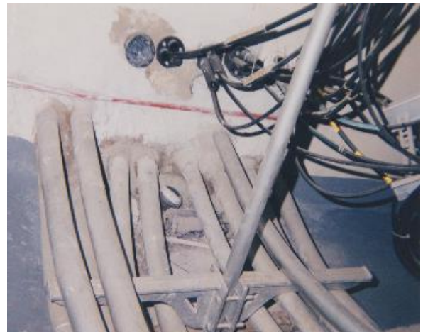
Fig. b No cuenta con barra de tierra de fosa de cables
