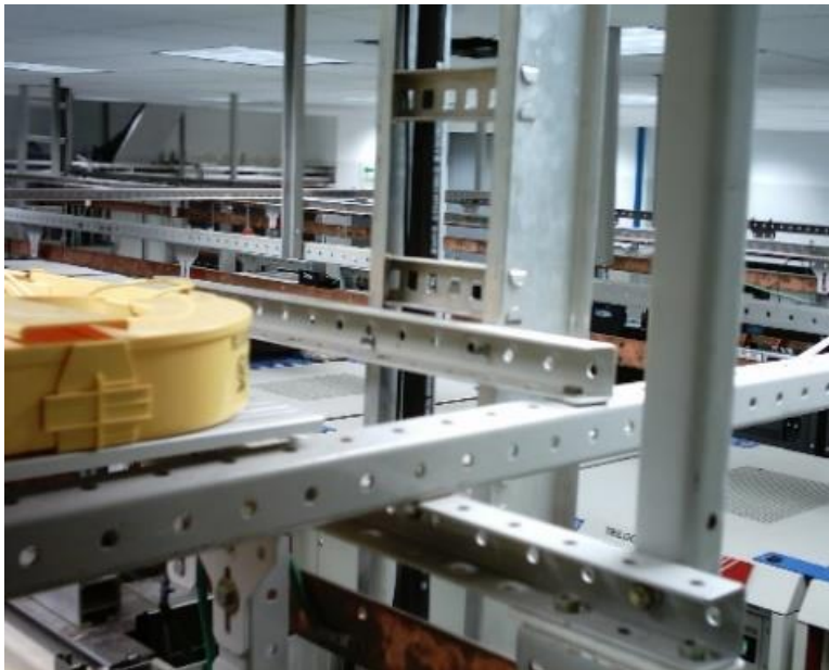
En la Fig. 06 Barra de Tierra de Equipo de Transmisión sin referencia a tierra.
