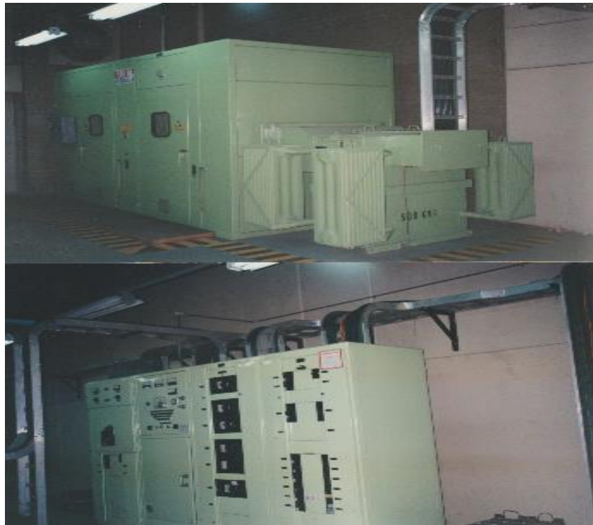
Fig. 08 Se muestra acometida y tableros.
