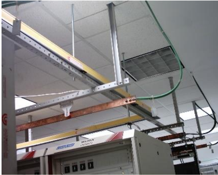
Fig. 23 Conexión del equipo de transmisión a la barra de tierra de equipo de transmisión
