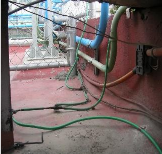
Fig. 10a Aire Acondicionado
