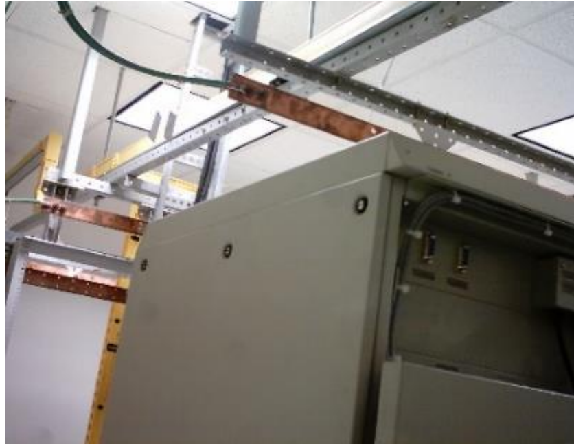
Fig. 21 Conexión de la barra de tierra de equipo de transmisión
