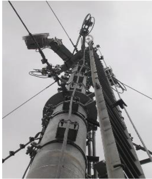
Fig. 15 Torre de transmisión arriostrada.
