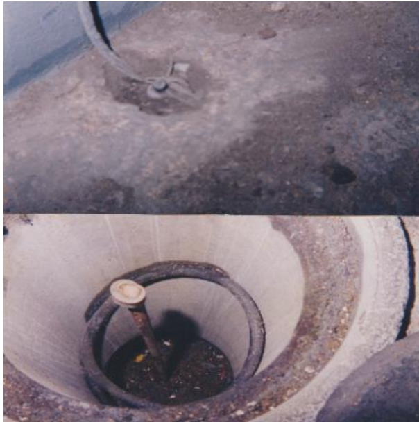
Fig. 01 Se observa que no se cumple con una malla debido a que solo existe un electrodo.
