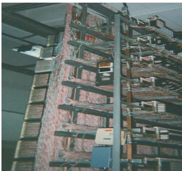
Fig. 03 Barra de tierra del distribuidor general sin referencia a tierra.
