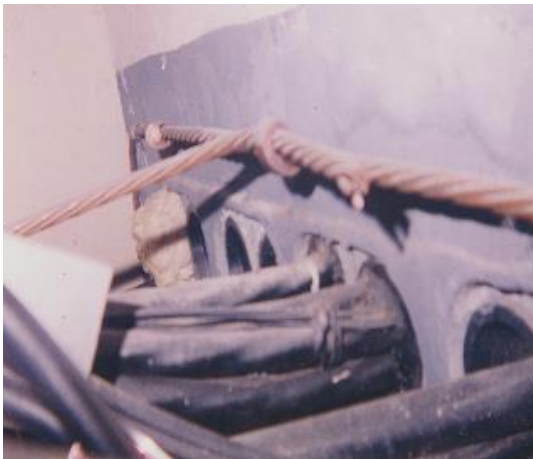
Fig. a No cumple con la barra de tierra de fosa de cables
