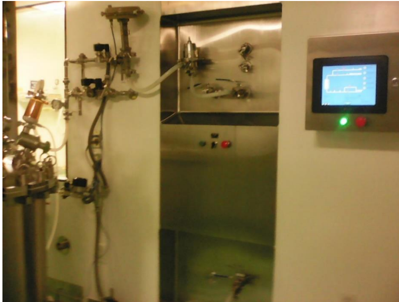
Img. 26 PLC en Funcionamiento
