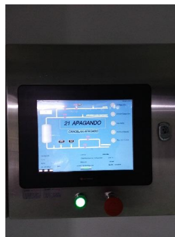
Img.81 Control auto cerrándose al concluir fin de ciclo
