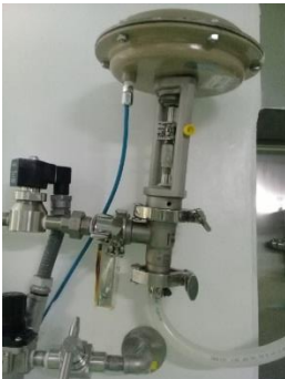
Img.47 válvula modulante
