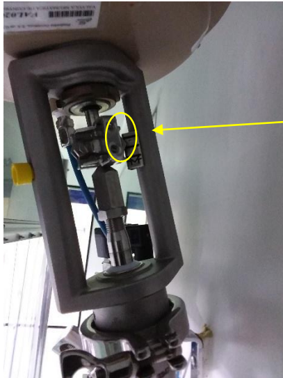
Img. 74 aperturas de válvula modulante
