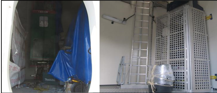
Foto 18.- Elevador del aerogenerador
