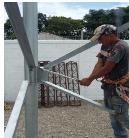
Foto No. 18. Placa de conexión
