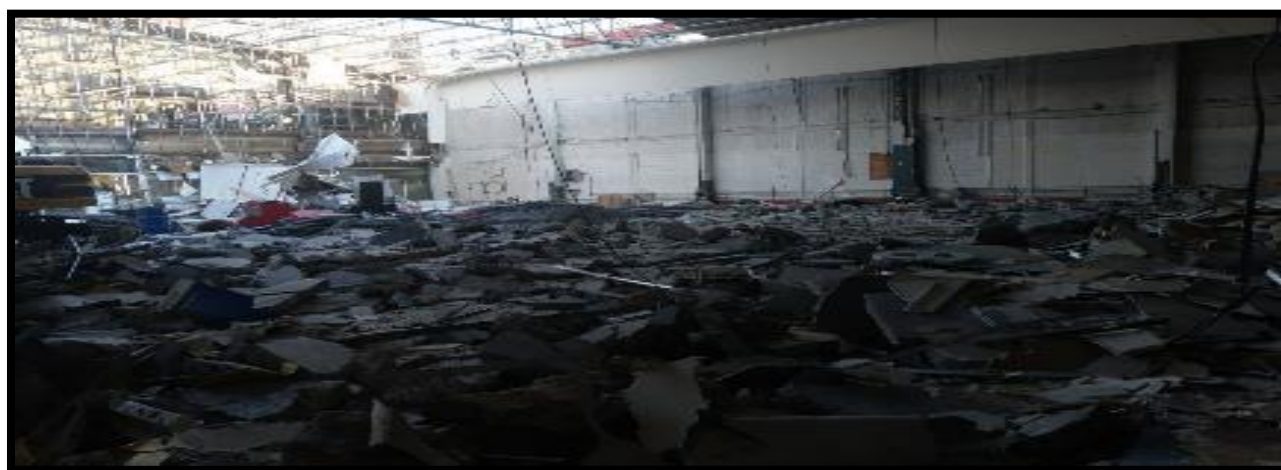
Imagen 3-6 Fuente: Demolición de subestructura con maquinaria, incluye firme y cimentación. Fuente: TOBSA Ingeniería Civil S.A. De C.V.
