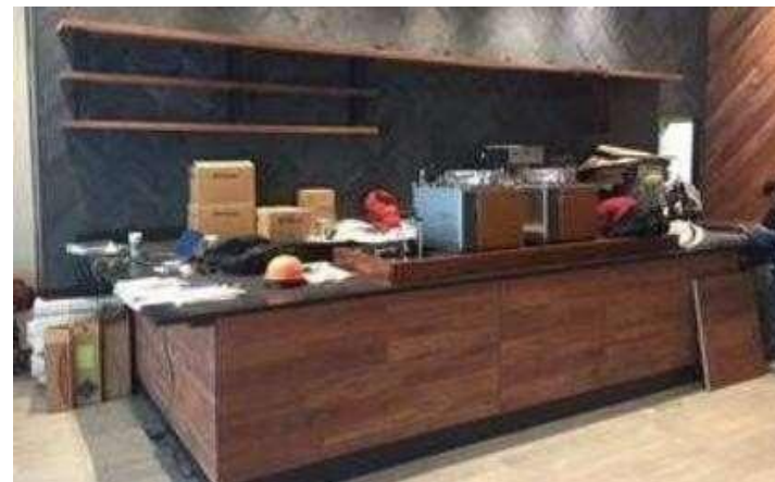
Fig. 32. Fotos de una sucursal CORE en proceso de instalación. Los gabinetes se fabricaron en MDF con laminado plástico, las cubiertas son de superficie solida Corian y paneles frontales de tzalam
