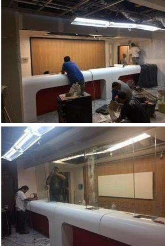
Fig 40. Fotos de instalación de mostradores, los cuales están fabricados en superficie solida y el interior con MDF y laminado plástico.
