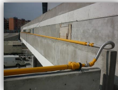
Ilustración 70. Tubería de gas.
