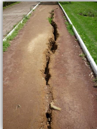
Ilustración 27. Grieta de Alameda.
