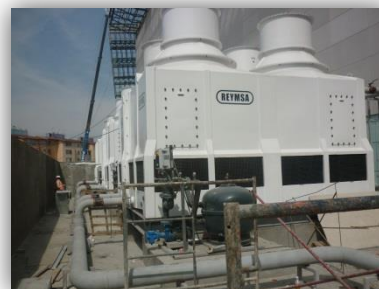
Ilustración 67. Equipos de A.A.
