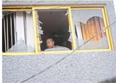
La onda expansiva alcanzó viviendas ubicadas a una cuadra del punto del siniestro, dañando ventanas y azulejos
