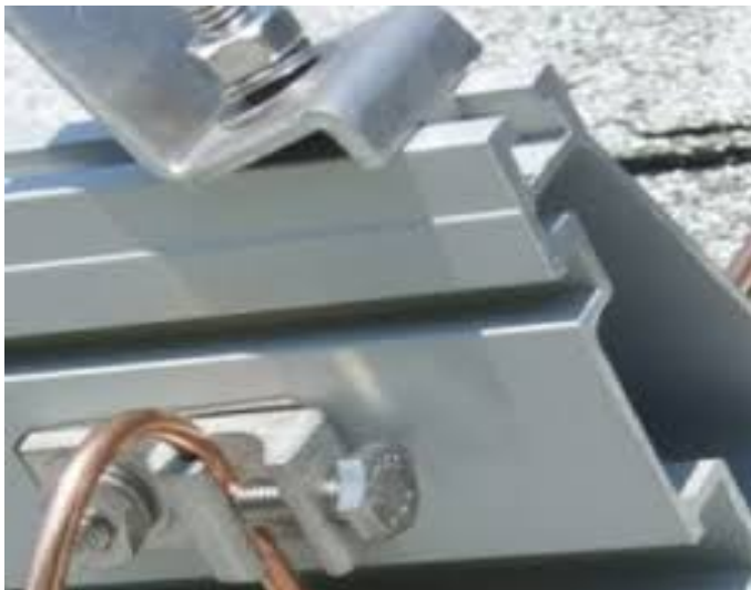
Figura 5.33: Puesta a tierra en una estructura de un SFV.
