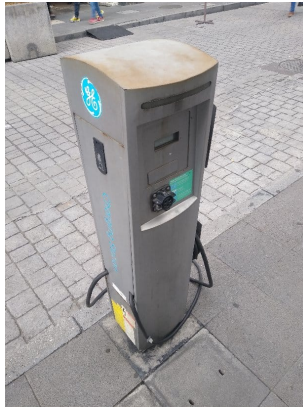
Figura 3.2: Cargador Tipo Poste en estación de carga, Sanborn's Villa de Cortes, Ciudad de México.
