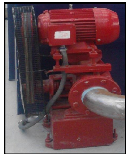
Figura 3.10 Bomba pinta con reja de seguridad instalada.
