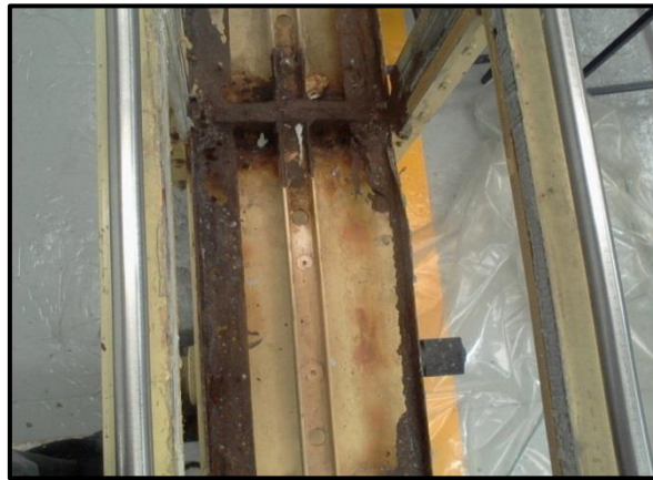
Figura 2.27 Estructura de acero dañada en la Sección I.
