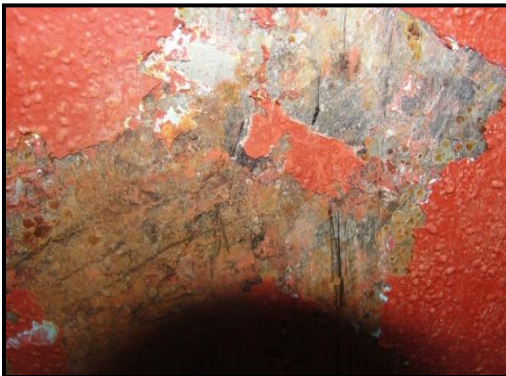
Figura 2.29 Oxidación típica y general dentro del tanque de contención.
