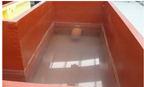
Figura 2.22 Codo Curva en el interior del tanque de contención.
