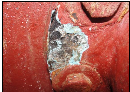
Figura 2.30 Daños general al tanque de contención debido a la oxidación.
