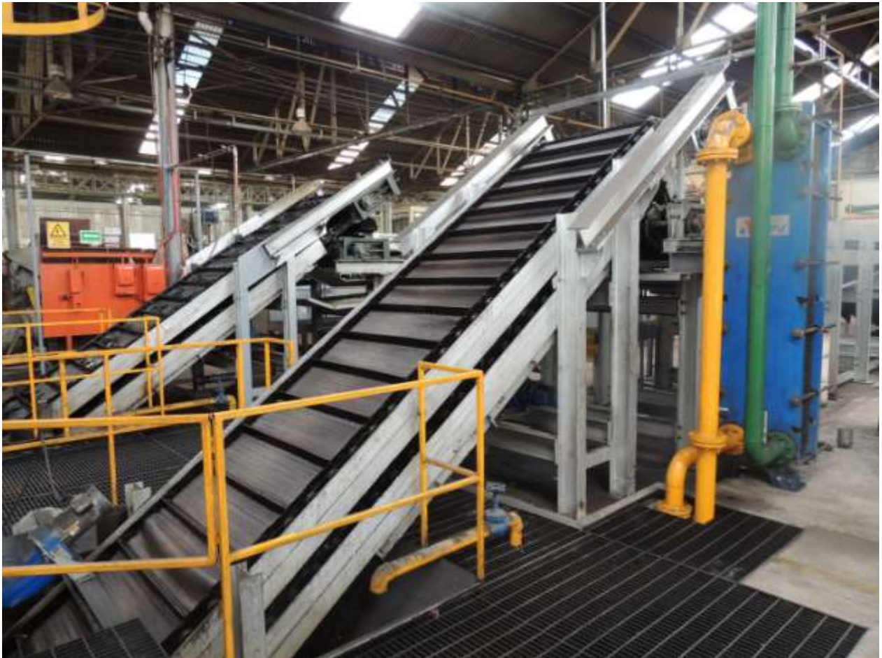
Figura 5.3.- Transportador de salida instalado en tina e intercambiador de calor.
