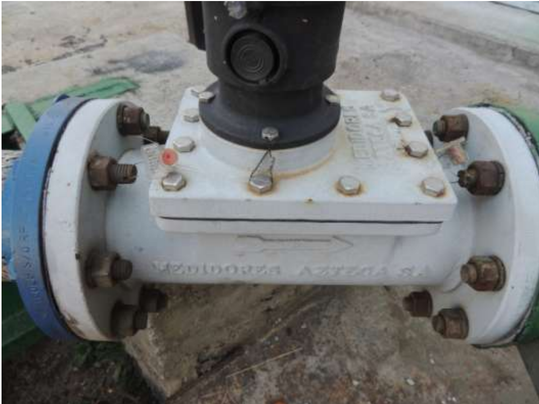
Figura 2.4.- Medidor marca AZTECA nuevo con sellos oficiales
