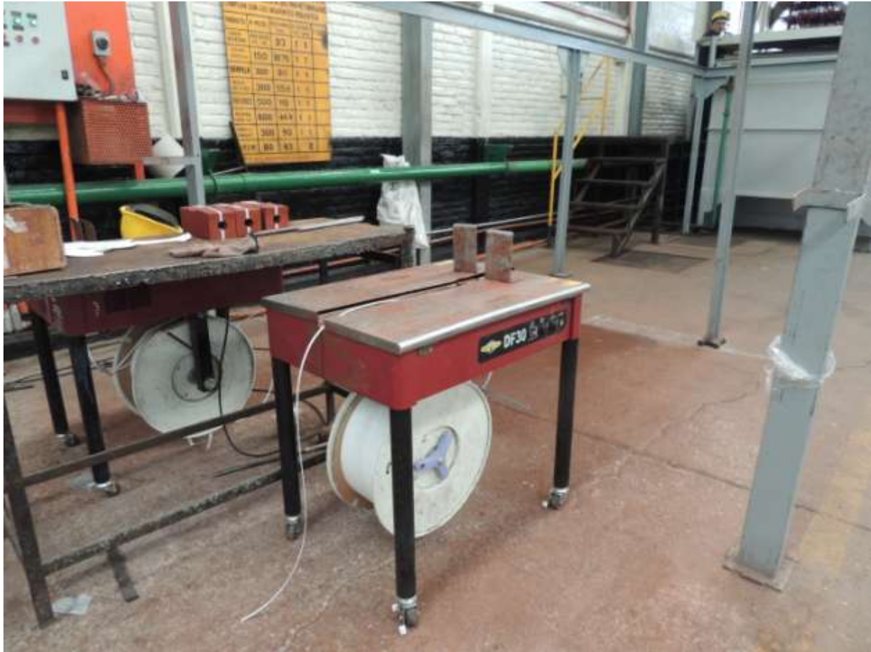
Figura 3.8.- Flejadoras DYNARIC® al final de la línea de pintura.
