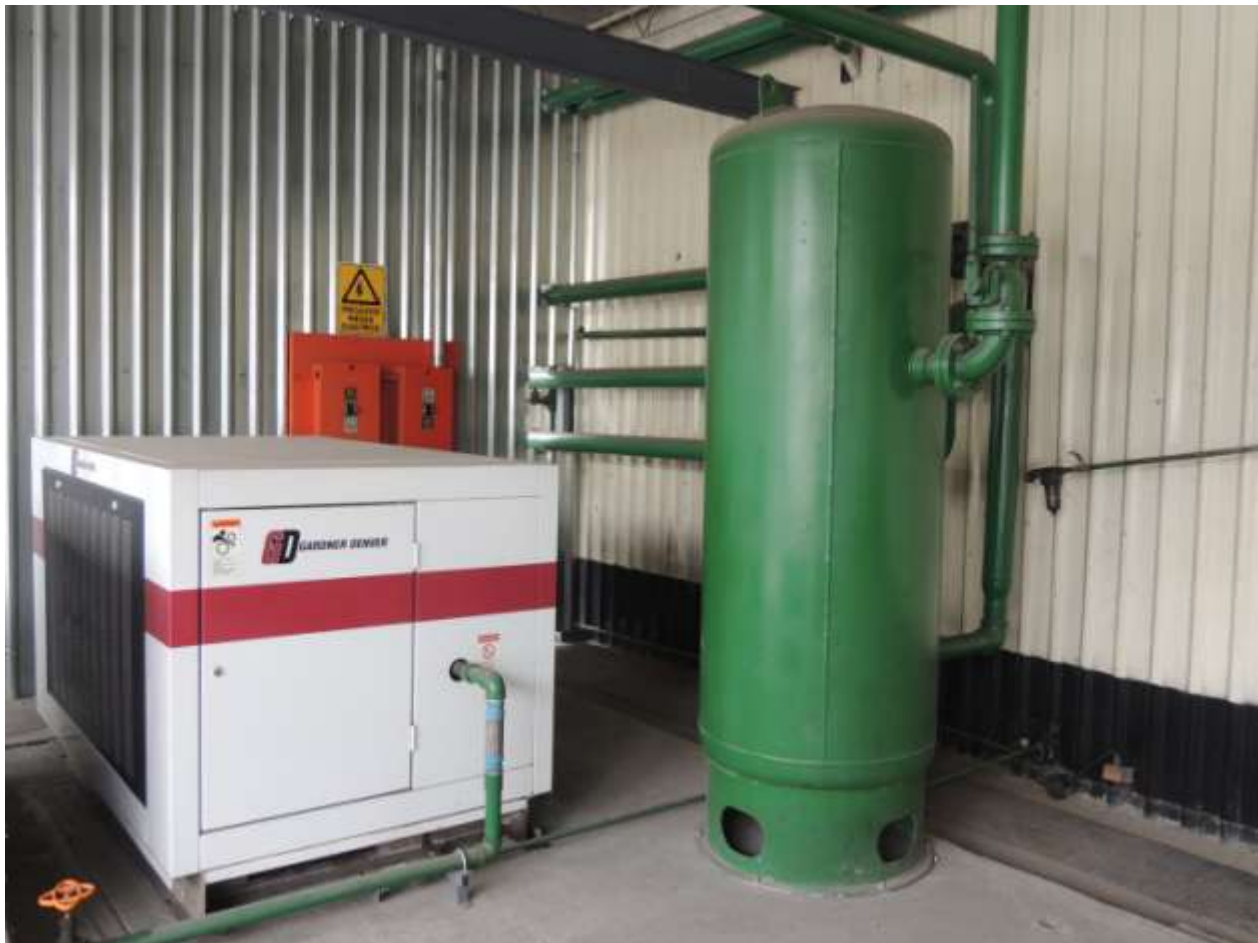
Figura 4.8.- Tanque único de aire comprimido de 960 L y compresor "A".
