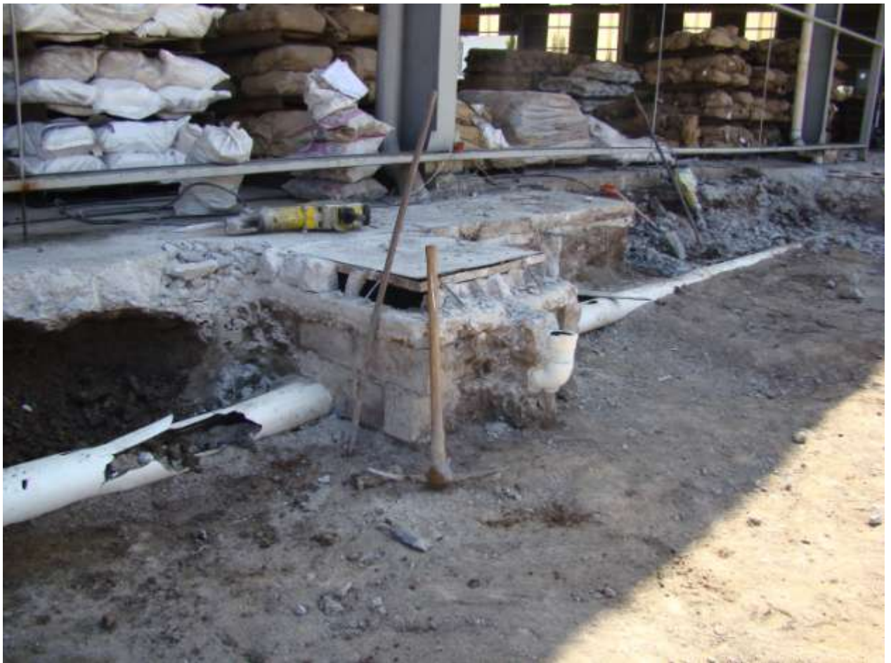
Figura 3.3.- Tuberías de drenajes pluviales de nave 4 dañados.
