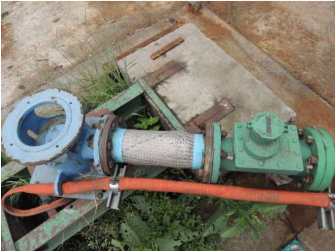
Figura 2.3.- exterior de pozo profundo, carrete flexible y medidor volumétrico dañado
