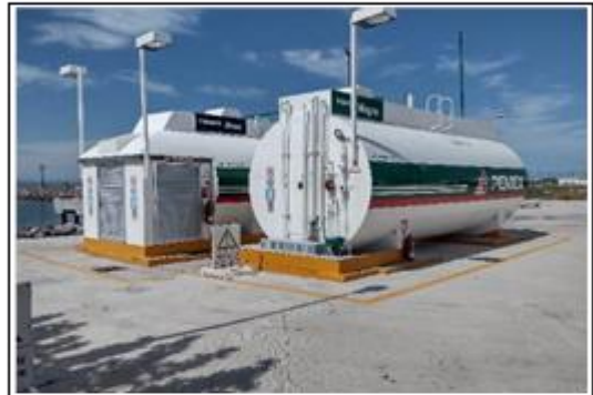
TANQUES DE ALMACENAMIENTO DE COMB.
