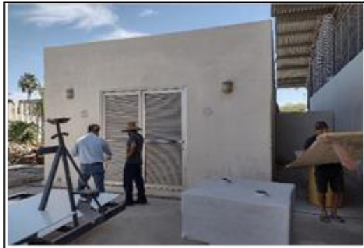
SANITARIOS EN ÁREA DE TALLERES
