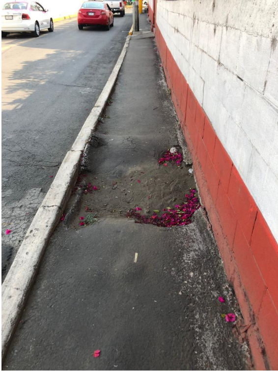
Imagen 43. Fotografía propia. Vista del mal estado de la banqueta.
