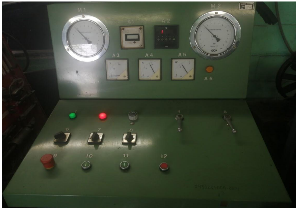
Figura 70. Banco de pruebas de motocompresor. (Hernández, J. Fotografía tomada en el taller de mantenimiento del tren ligero, el día 23 de agosto de 2022, Huipulco CDMX).
