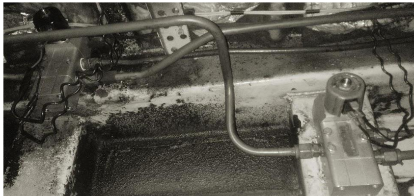
Figura 23. Electroválvulas puerta de operador. (Hernández, J. Fotografía tomada en el taller de mantenimiento del tren ligero, el día 27 de mayo de 2022, Huipulco CDMX).
