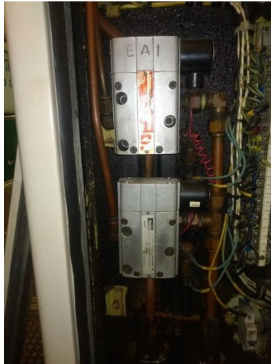
Figura 22. Electroválvulas de apertura y cierre de puertas. (Hernández, J. Fotografía tomada en el taller de mantenimiento del tren ligero, el día 27 de mayo de 2022, Huipulco CDMX).
