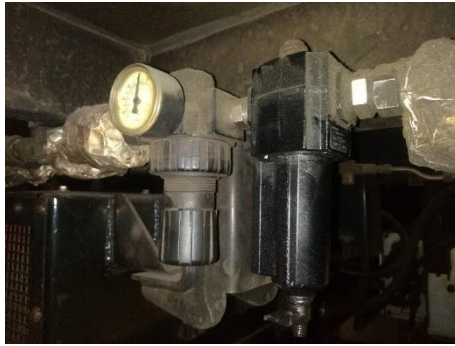
Figura 54. Regulador de presión. (Hernández, J. Fotografía tomada en el taller de mantenimiento del tren ligero, el día 28 de junio de 2022, Huipulco CDMX).
