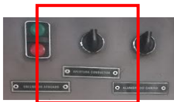
Figura 64. Selector apertura puerta de operador. (Hernández, J. Fotografía tomada en el taller de mantenimiento del tren ligero, el día 18 de agosto de 2022, Huipulco CDMX).
