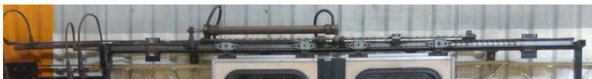
Figura 68. Cierre del mecanismo. (Hernández, J. Fotografía tomada en el taller de mantenimiento del tren ligero, el día 7 de junio de 2022, Huipulco CDMX).
