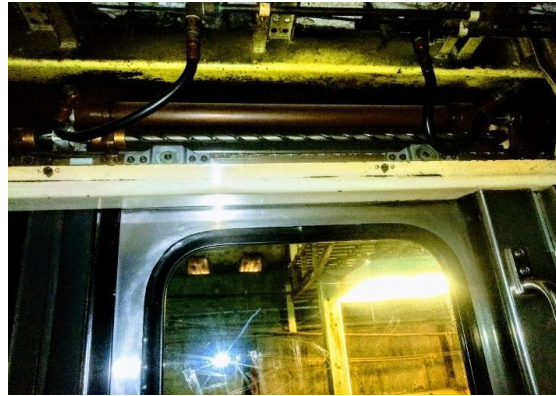
Figura 25. Cilindro neumático. (Hernández, J. Fotografía tomada en el taller de mantenimiento del tren ligero, el día 7 de junio de 2022, Huipulco CDMX).
