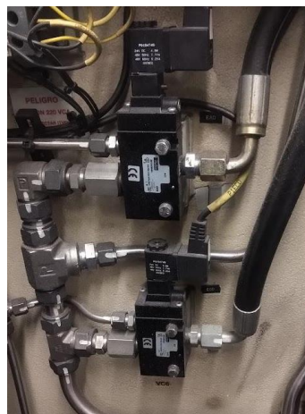
Figura 24. Electroválvulas B6. (Hernández, J. Fotografía tomada en el taller de mantenimiento del tren ligero, el día 27 de mayo de 2022, Huipulco CDMX).
