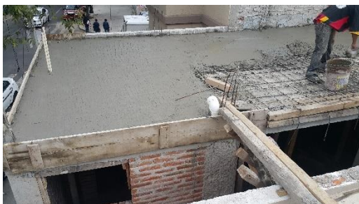
Imagen 80. Colado de losa de azotea sobre recámara principal y baño. Autoría propia
