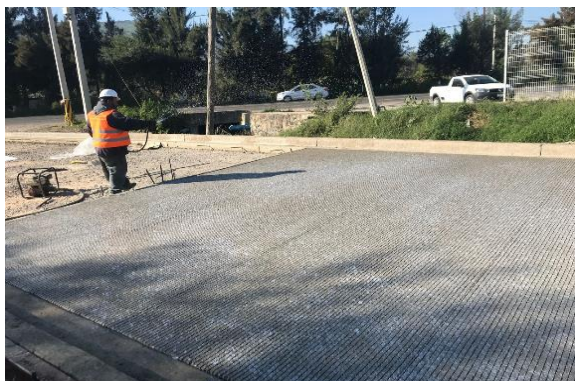
Imagen curado de concreto, autor Ulises Romero, residente de obra, 21 de abril de 2018
