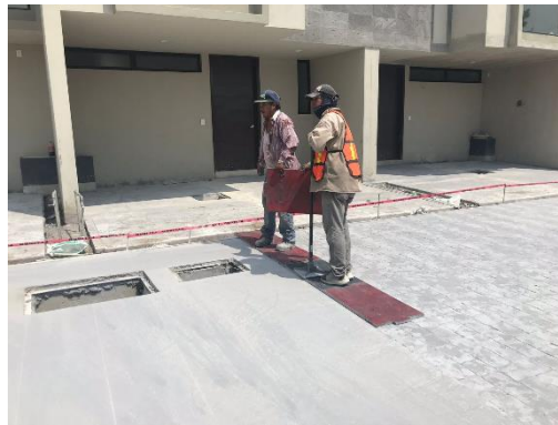
Imagen estampado de concreto, autor Raymundo Miranda, residente de obra, 03 de noviembre 2019
