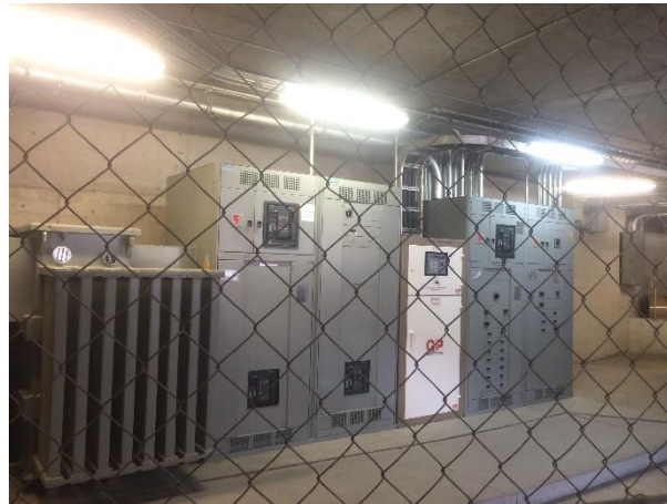
SUB-ESTACIÓN ELÉCTRICA (SEM-SÓTANO)
