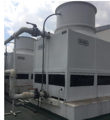
TORRE DE ENFRIAMIENTO
