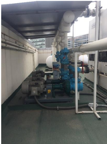
EQUIPO DE BOMBEO (A.A)
