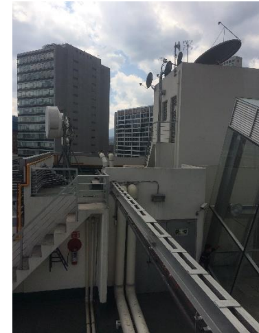
CUARTO DE MAQUINAS MONTACARGA
