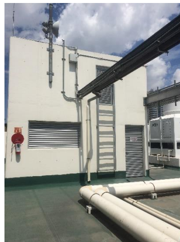
CUARTO DE MAQUINAS ELEVADORES
