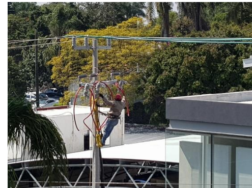
CONEXIÓN CUCCHILLAS DE OPERACIÓN
