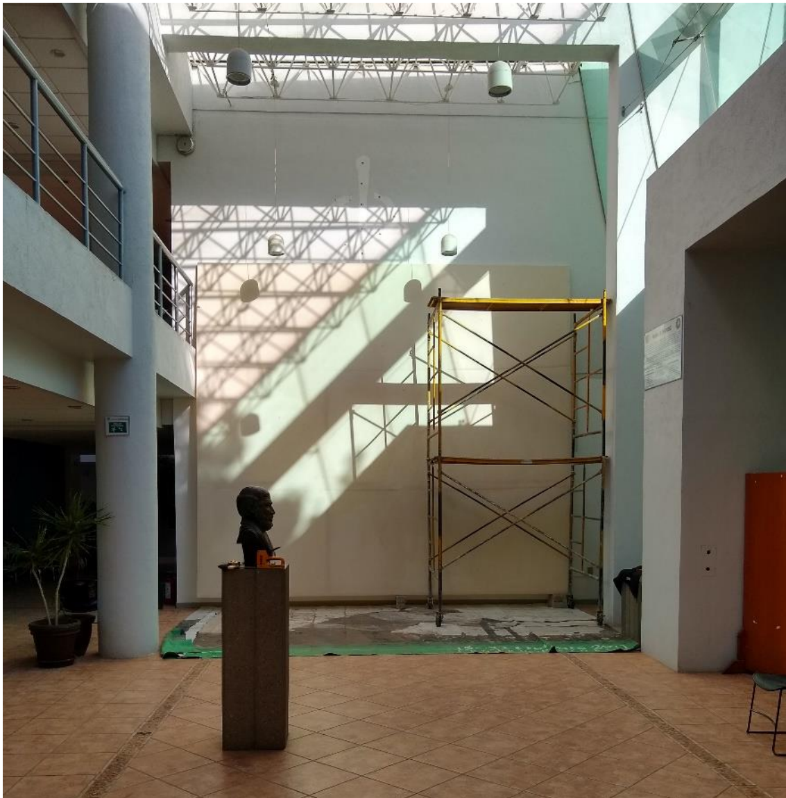
Ilustración 213: Espacio donde sería instalado el mural Voluntad de vivir , bastidor armado y andamio utilizado. Foto: Imuris Aram Ramos Pinedo 2021.
