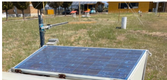
Figura 7.8: Panel Solar de la estación de RS en México.
