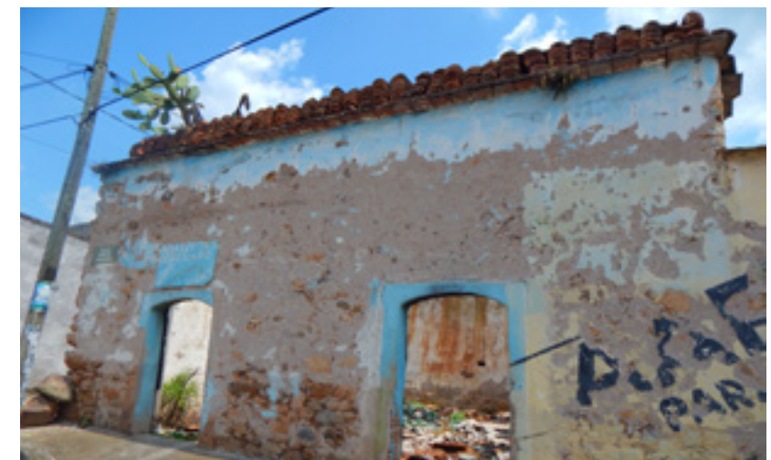
(1.10) Un ejemplo de las múltiples casas abandonadas en Piñicuar, se puede observar el techo caído y falta de ventanas y puertas.
