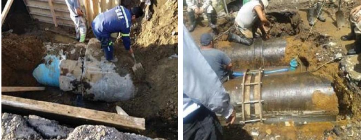
Fig. 4.20 Fugas en red primaria de la Ciudad de México derivadas del sismo del 19 de septiembre de 2017 (Ayala, 2019).
