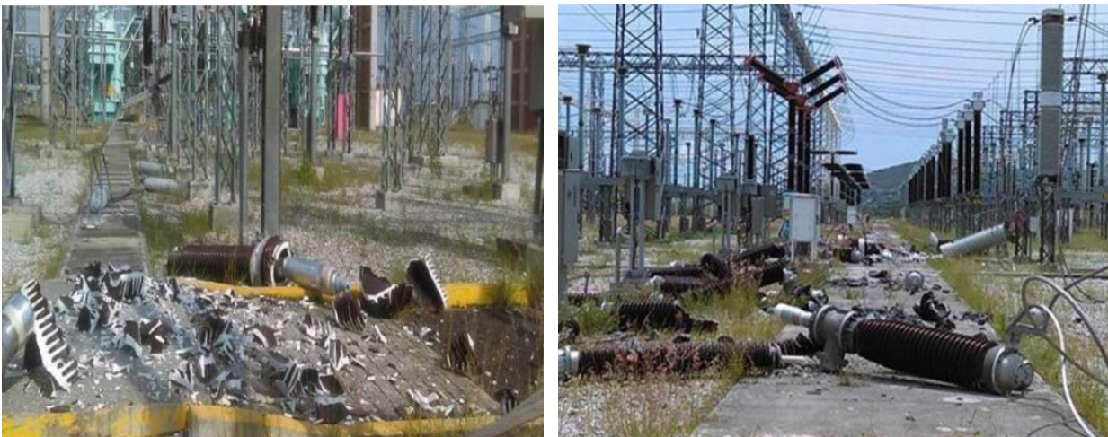
Fig. 4.19 Daños en la subestación Yautepec. Morelos ocasionados por el sismo del 19 de septiembre de 2017 (Imagen tomada de González N., 2017).
