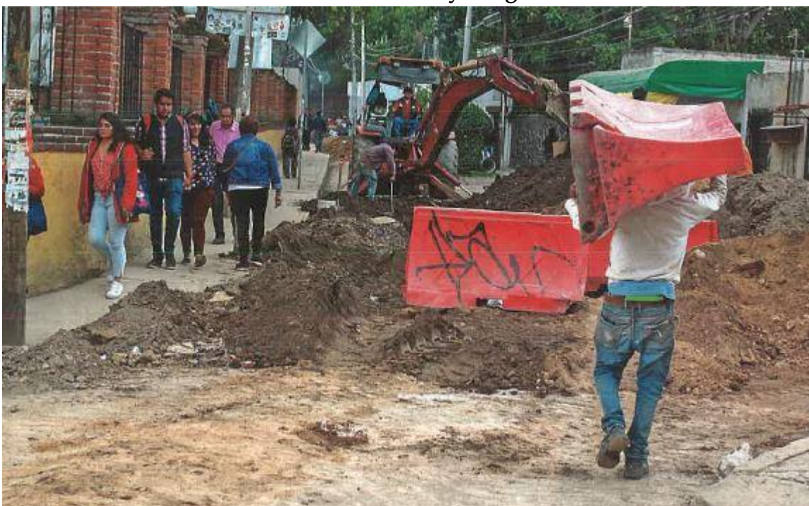
Figura 4.9 Alcaldía Benito Juárez, Ciudad de México: carril bloqueado por obras en calle Real de Mayorazgo 2019.
