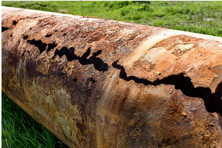
Figura 3.1. Corrosión presente en un ducto que se encuentra expuesto al medio ambiente [8]
